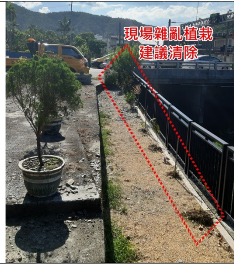
現場雜亂植栽建議清除
