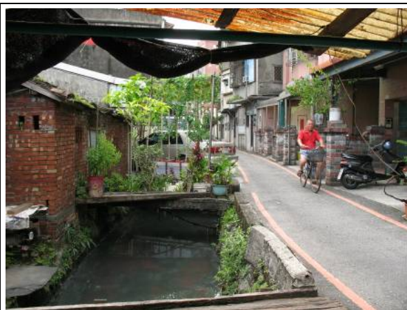
施工前-護岸損壞，環境雜亂
