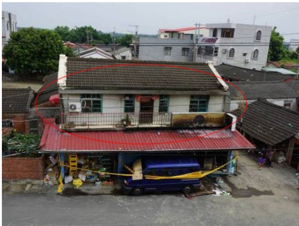
圖1 火災現場窗戶均使用鐵窗
