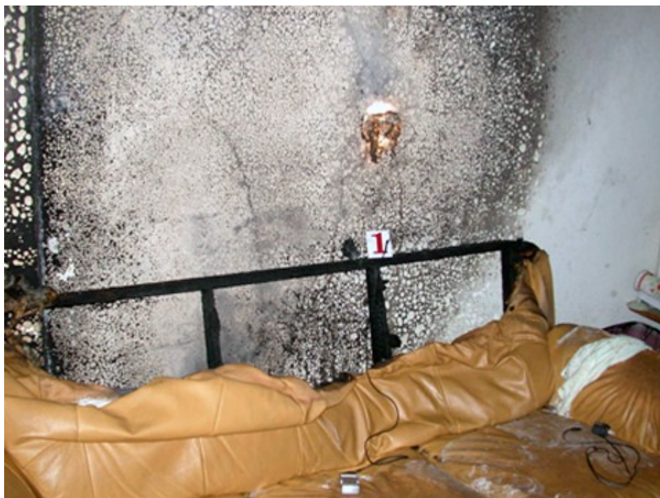
圖4：1樓客廳僅內部東側沙發椅上方處受火勢燒損、碳化。
