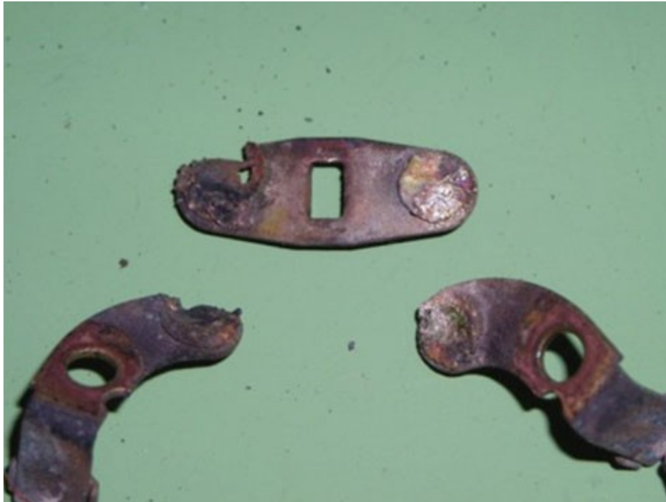
圖 9：壓力開關接點燒熔處分解。
