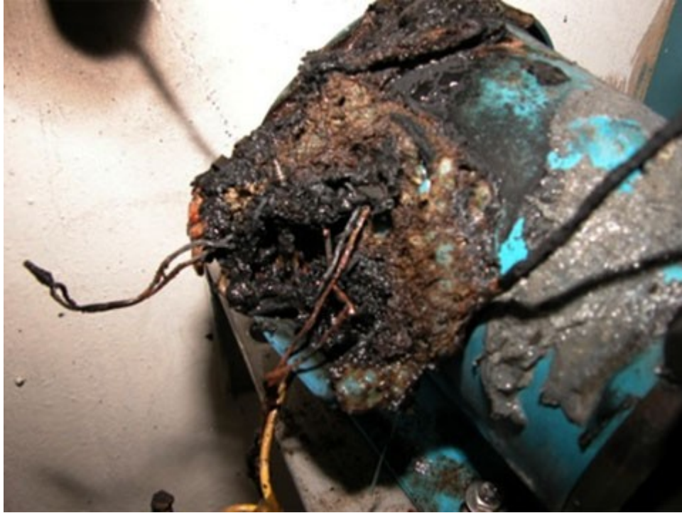
圖 7：泵浦接線盒燒熔，貫穿馬達外殼的電線有熔痕。
