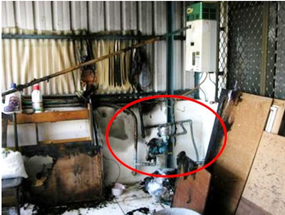
圖 1：加壓泵浦牆面接線盒處燻黑。
