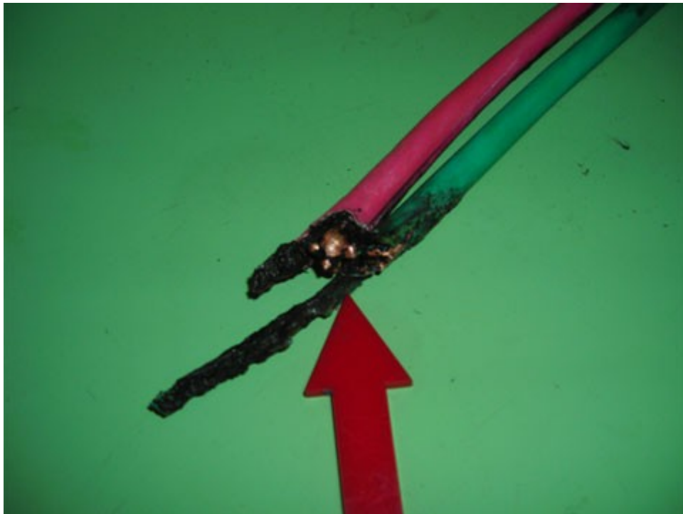
圖 6：電纜線短路情形（紅色與綠色電線短路）
