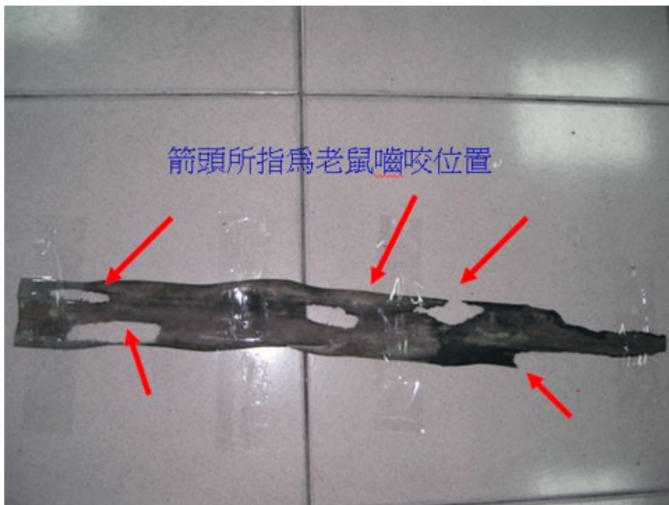
圖 3：電線披覆受老鼠嚙咬情形
