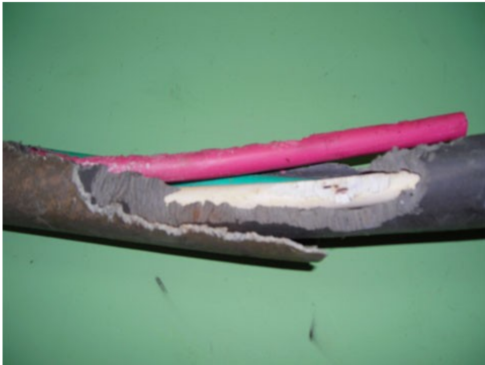
圖 4：電線披覆受老鼠嚙咬情形
