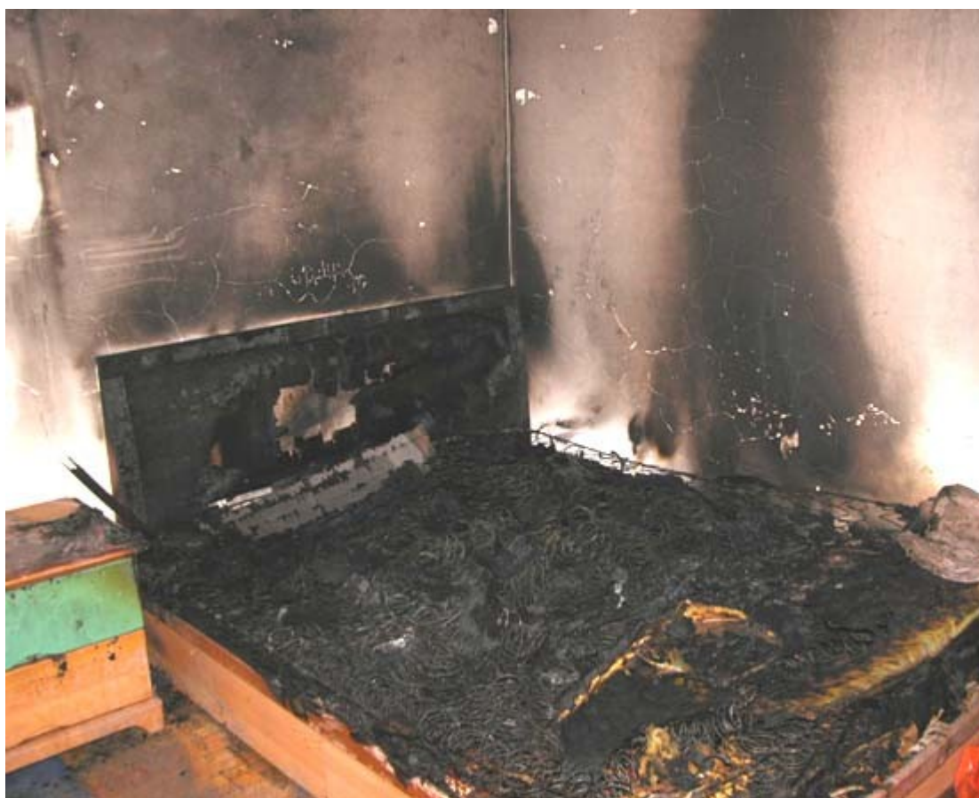
圖1：房間床鋪上方右側牆面留下燻黑變色煙柱。
