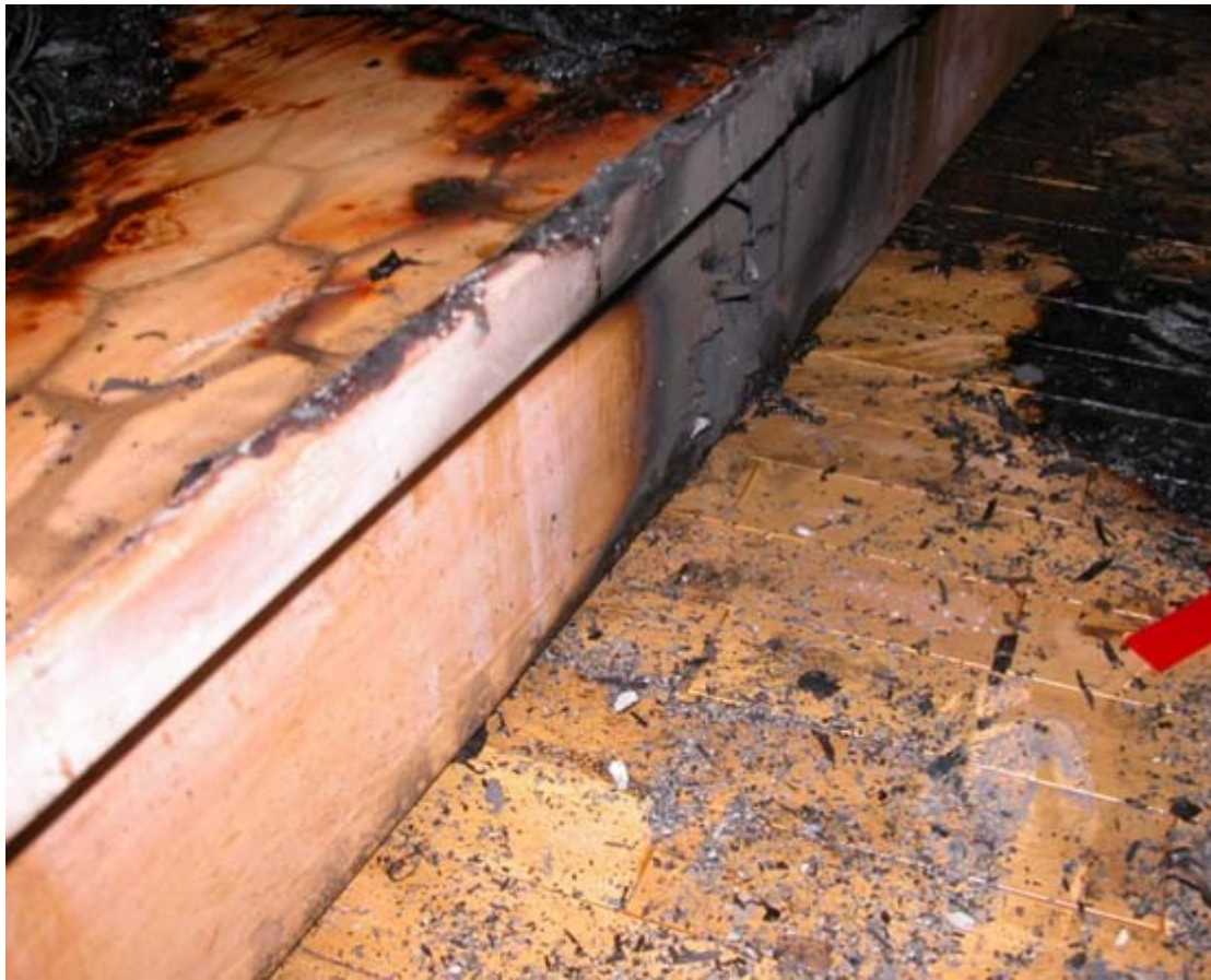
圖 3：移動床鋪發現床鋪與木質地板碳化（床鋪側）。
