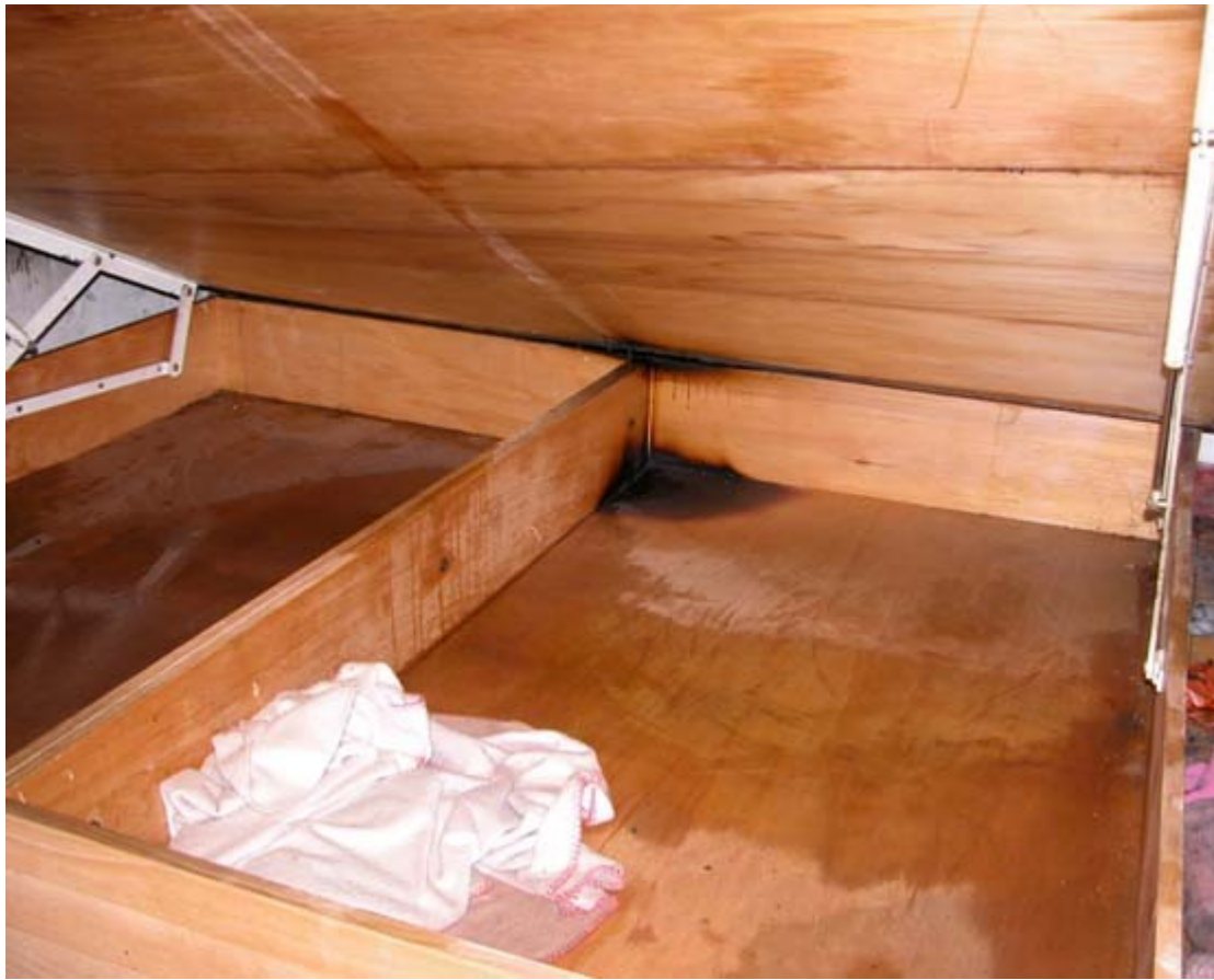
圖 2：床鋪下方右側發現接近地板面碳化較嚴重。
