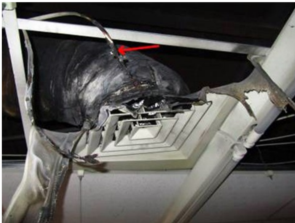
圖1：受燒毀之天花板出風管口處，發現該管口管徑外壁處緊靠著1條1.6mm實心電源白扁線受燒斷情形。
