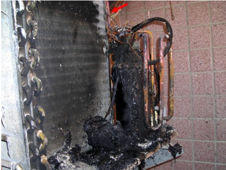
圖1：室外機出風側，冷凝器右側受燒泛白（紅箭頭），左側外殼塑膠尚存。
