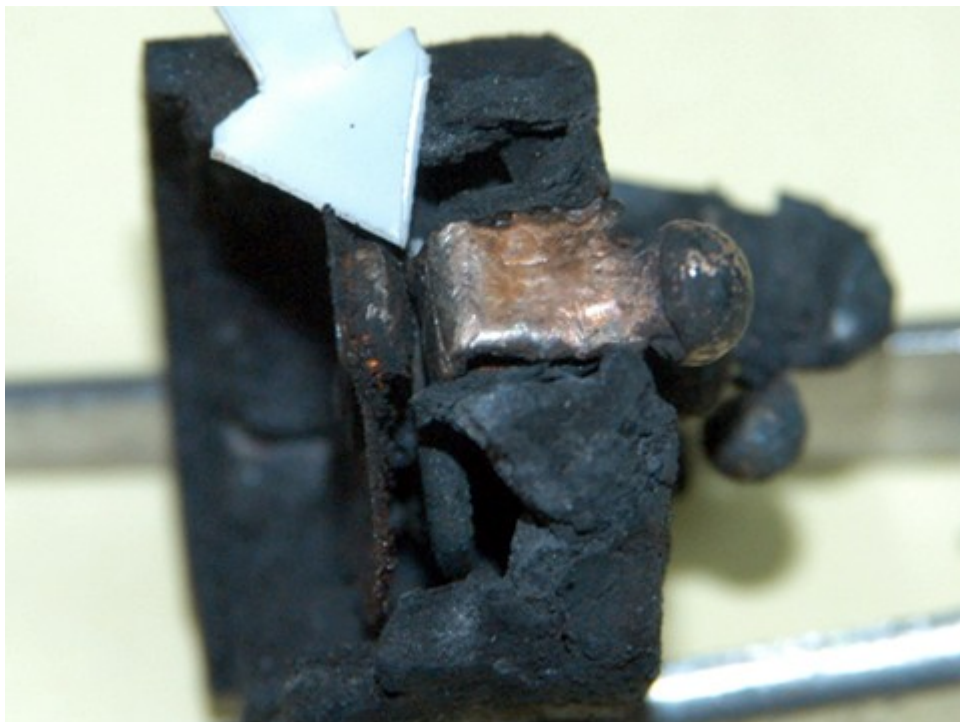
圖 6：過載保護器引出接點（B）短路熔痕，剪開外殼發現引出接點與可動接點間已無間隙（白箭頭），造成過載保護器失效。
