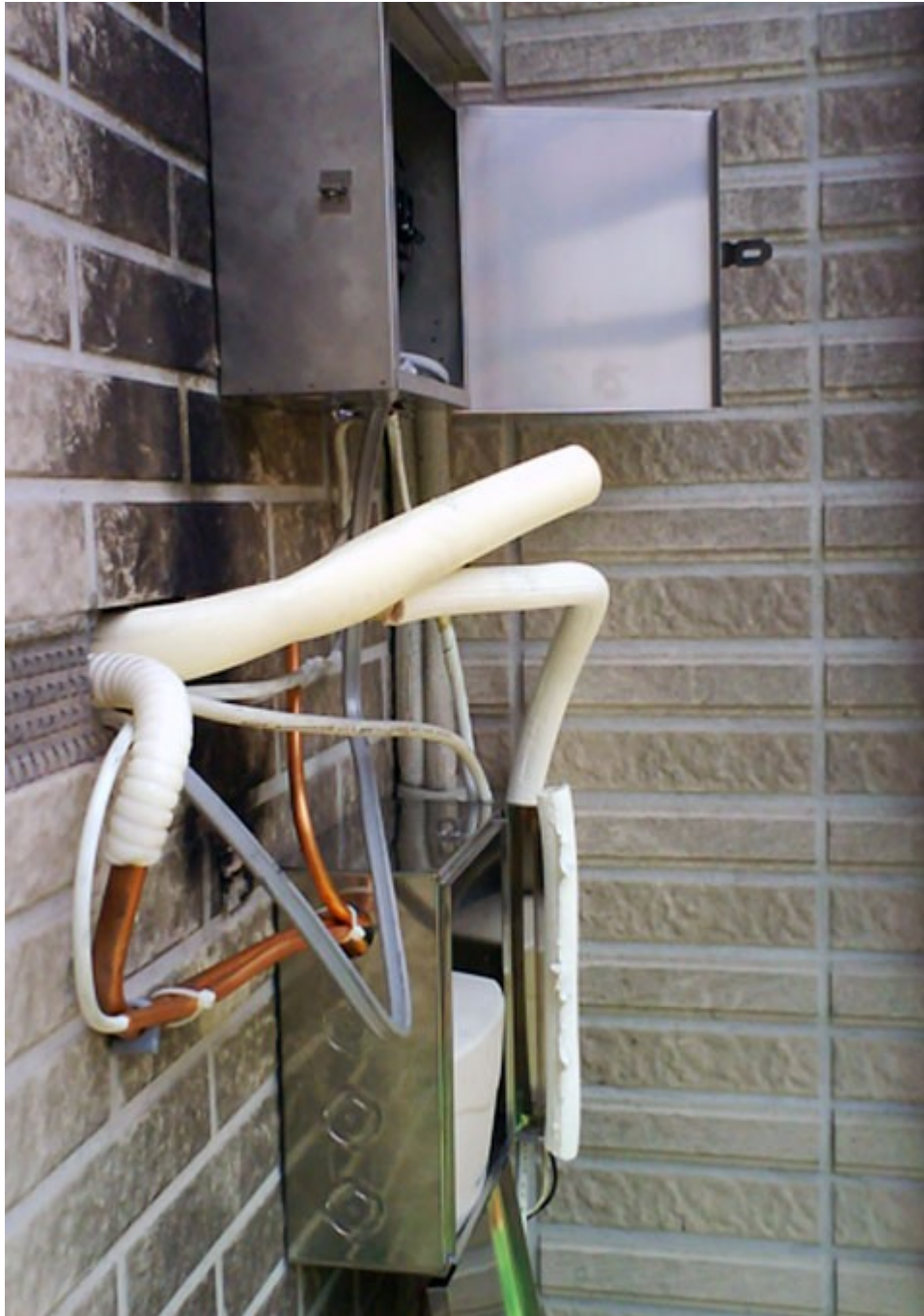
圖 8：修理後之排水器設置改良情形（業者加裝防雨外罩及回路過載開關）。
