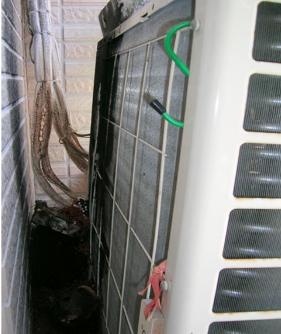
圖 4：室外機外部燻黑嚴重。
