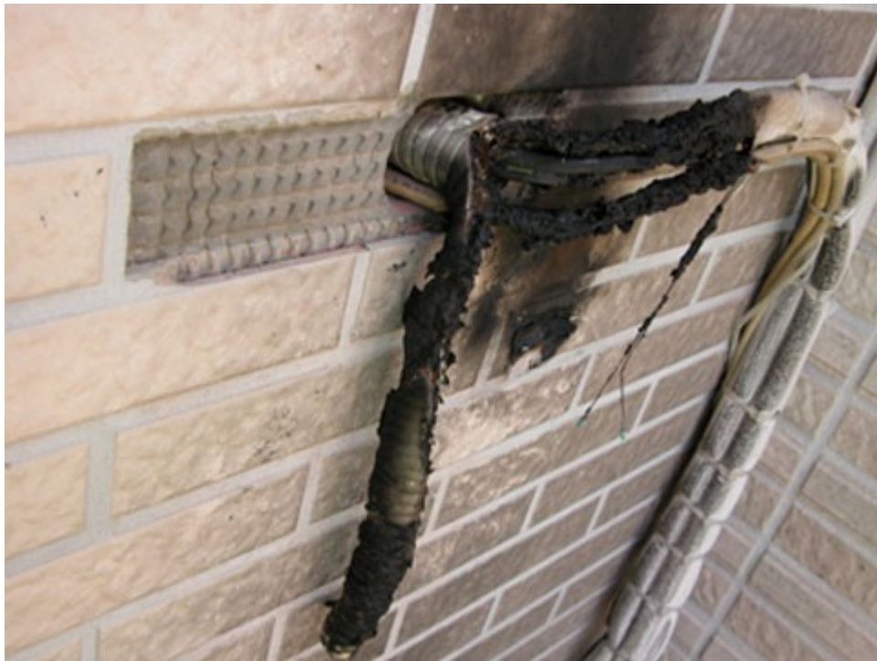
圖 2：排水器安裝位置，貫穿部電線未受燒。
