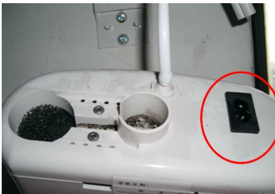
圖 9：正常排水器的電源轉換接頭。
