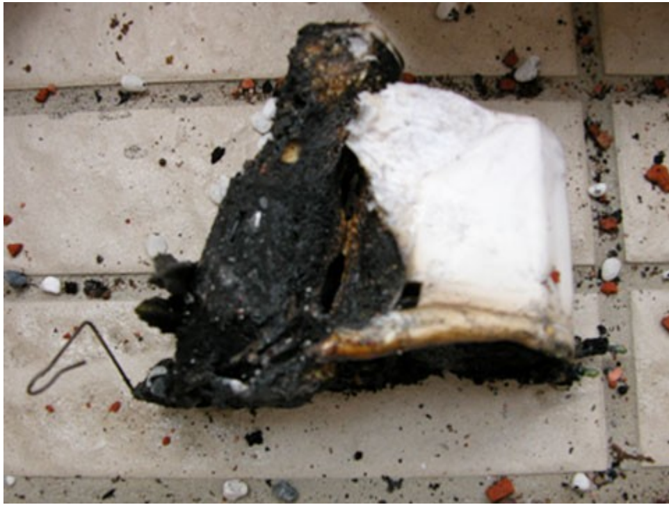
圖 3：排水器燒熔情形。
