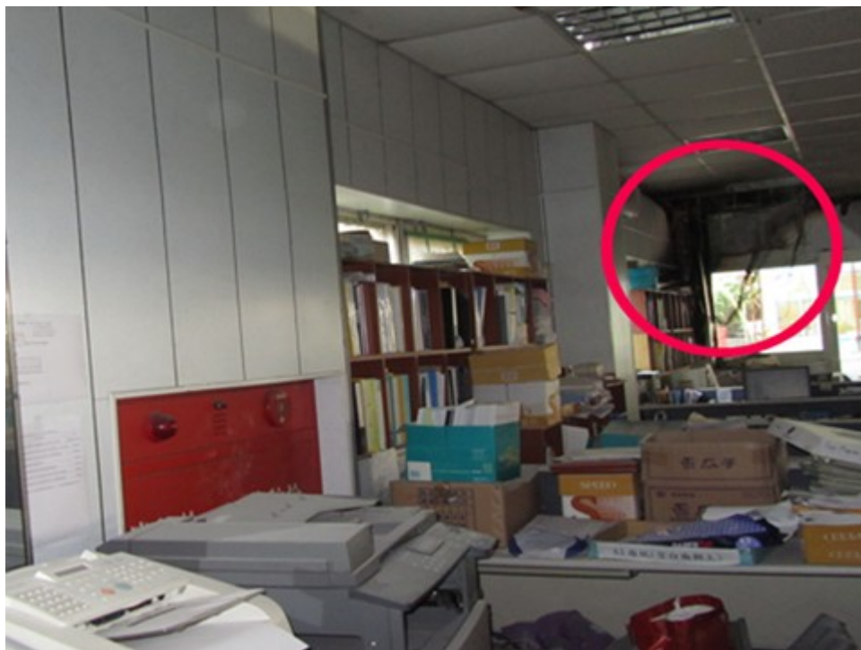
圖 1 消防人員到達現場時僅發現東北側角落位置木板裝潢牆壁及天花板受燒毀情形
