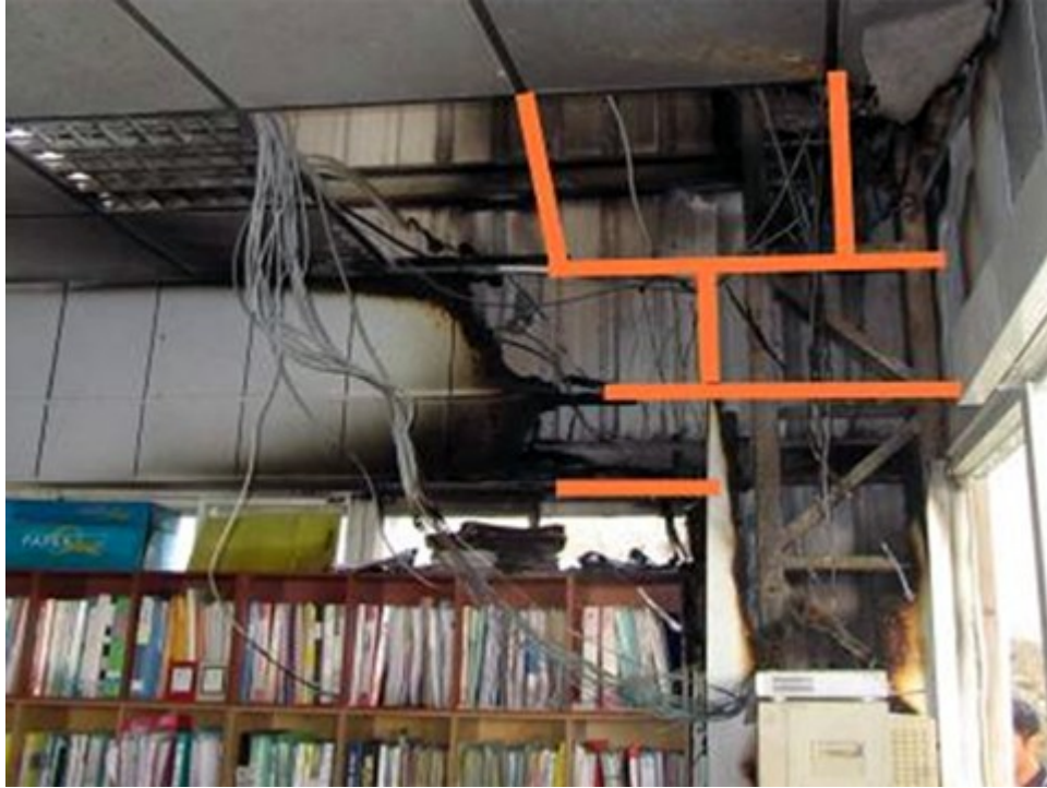
圖 2 觀察發現該處附近裝潢的木頭角材支架有受嚴重燒穿碳化情形，顯示起火位置應
