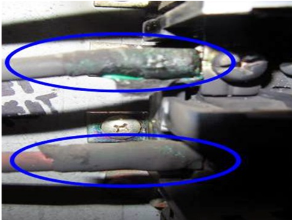
圖 7 觀察總電源開關配電箱電磁閥開關，發現該冷氣機配電線路連接電磁閥開關接頭處之 PVC 絕緣皮及塑膠貼布有燒熔變色情形，可顯示因電源線路產生短路情形，無熔絲開關負載端接頭呈現電弧焦耳熱現象。
