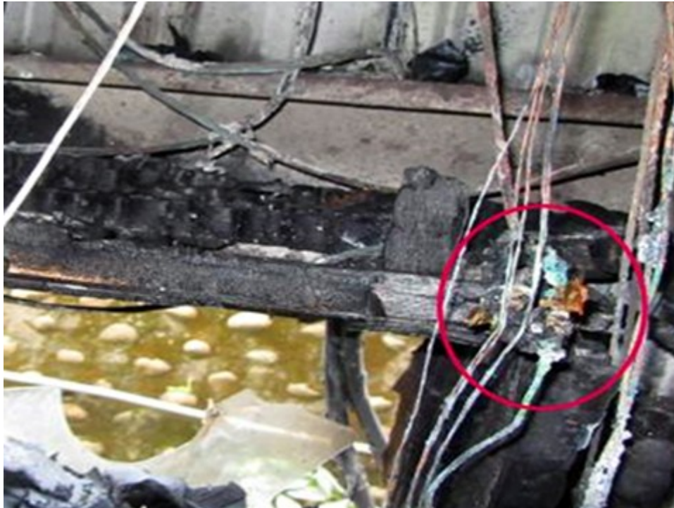
圖 3 尋找觀察該處較大線徑之電源線路，可發現靠近於天花板附近處有裝置一具三相 220 伏特之冷氣電源插座受嚴重燒毀情形。
