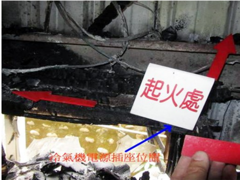
圖 10 本案起火處以該冷氣機電源線插座處為起火處，起火原因以冷氣機插頭連接處接觸不良產生焦耳熱，致黏貼插頭處防漏電塑膠布因受熱起火燃燒，瞬間引發通電短路再引燃冷氣機塑膠插座引火致災之可能性無法排除。
