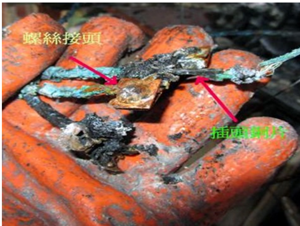
圖 4 將該冷氣機插座拆下觀察發現該冷氣機電源插座塑膠外殼均已嚴重燒熔燒 失僅殘 留部分螺絲接頭及插頭銅片。
