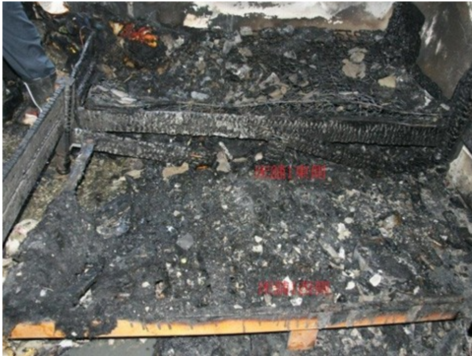
圖3：清理觀察床舖1燒毀情形，以中間吹風機殘骸附近最為劇烈嚴重，木床板及木架燒失碳化變色情形，以東側較西側嚴重、南側較北側嚴重。
