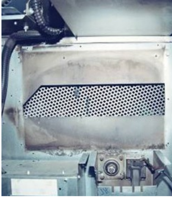
圖 5. 烘衣機之燃燒室與滾桶中間濾網(面向燃燒室一側)有燃燒殘餘物附著。
