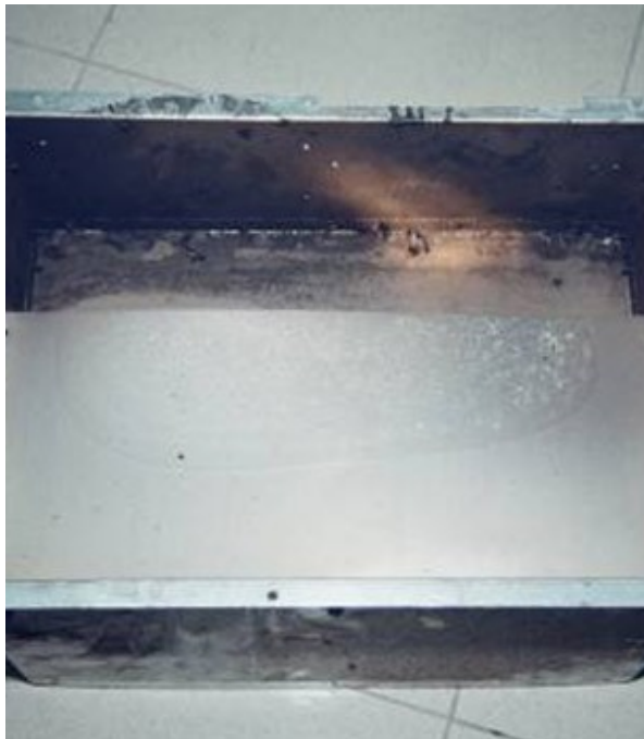
圖 4. 燃燒室內有殘留灰塵及棉絮。
