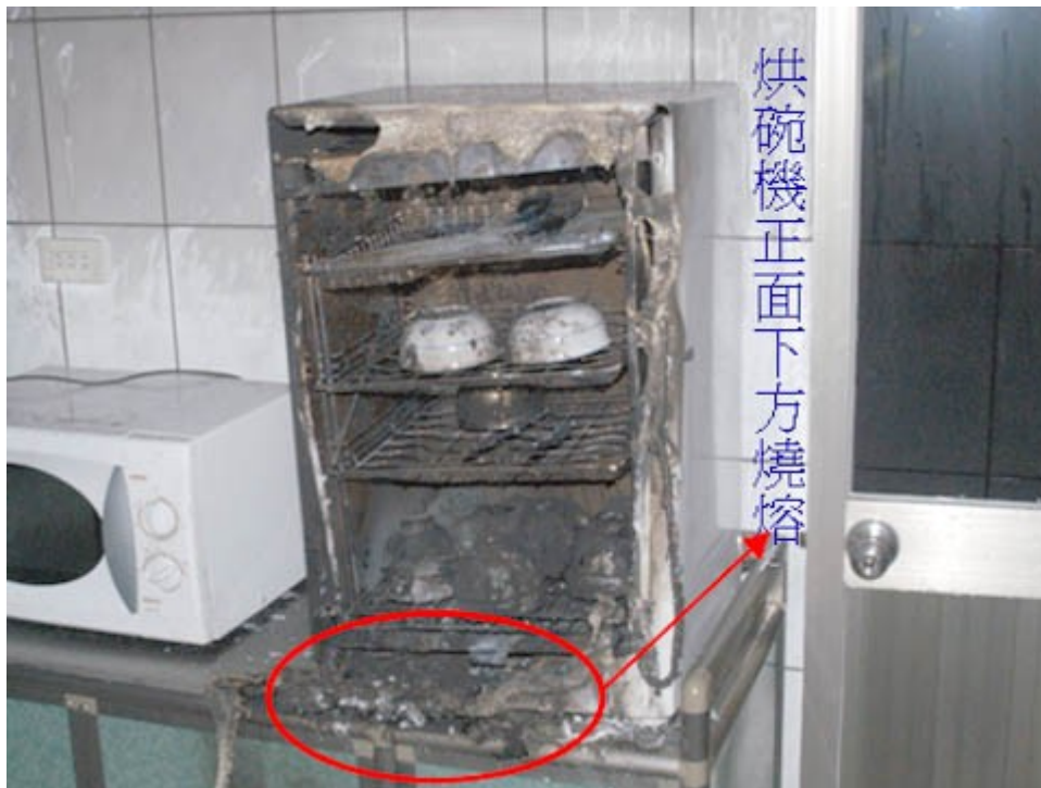
圖 1：烘碗機正面受燒，以右下方（控制面板）受燒嚴重。
