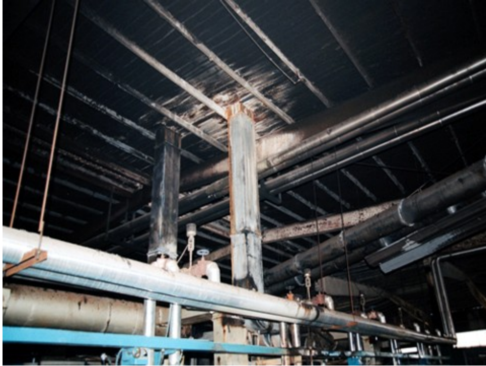
圖 2. 第 3 台定型機熱排氣管及鐵皮燒損情形
