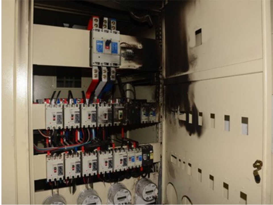
配電箱有受燒碳化情形。
