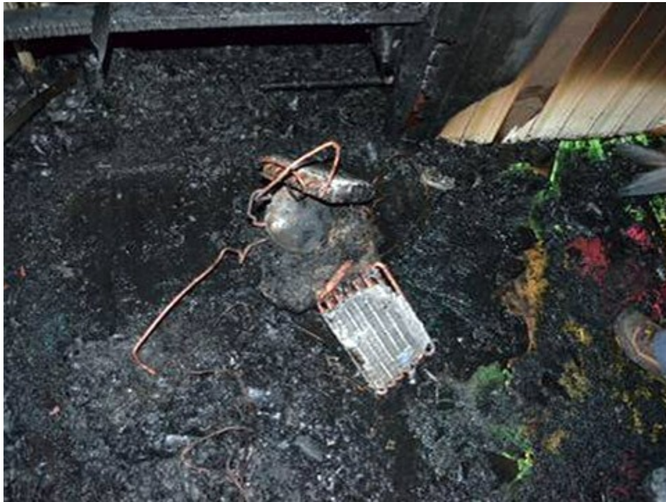
圖 4：清理除濕機附近，發現木質地板有受熱碳化之情形，巧拼靠除濕機側亦皆燒失。
