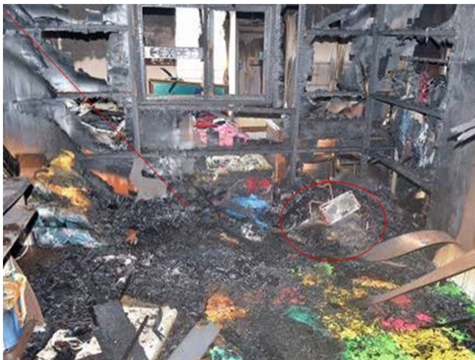
圖2：「臥室2」北面木質隔間牆有受燒碳化及燒失之情形，角材碳化外露，西側合板及地面單人沙發椅受燒後可見一「西高東低」之斜線火流，中央地面可見有一燒熔倒榻之電風扇，東側有一塑膠外殼燒失，冷卻器外露之除濕機。
