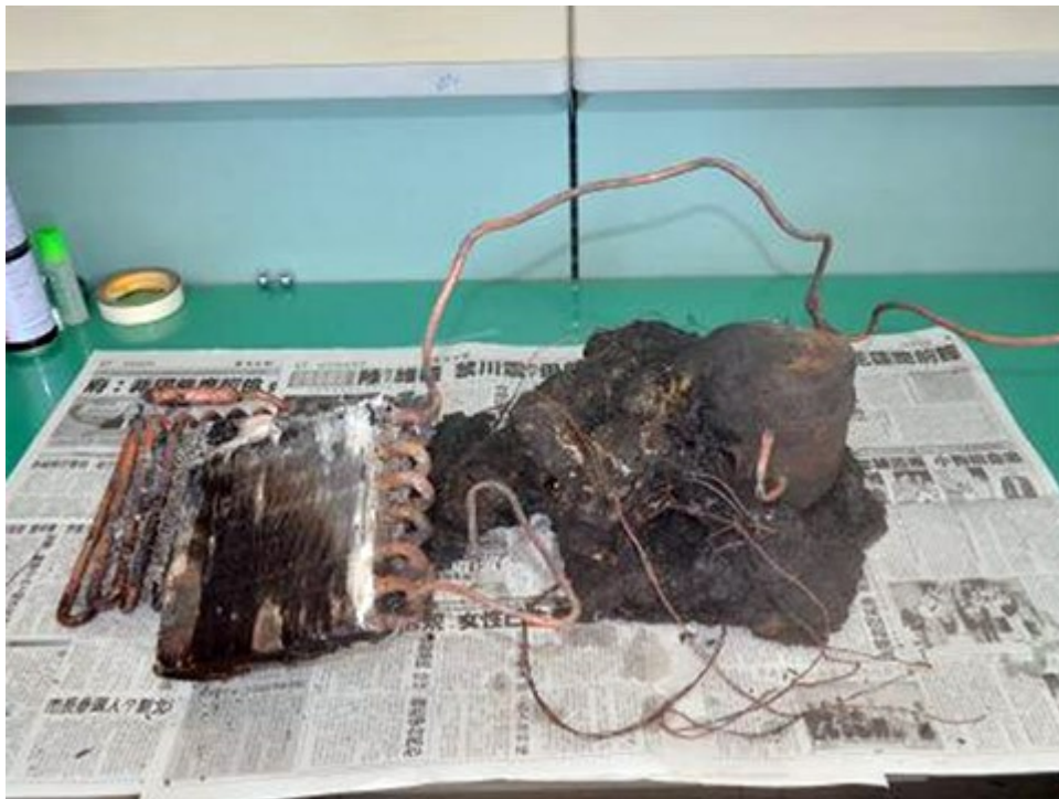
圖 5：除濕機塑膠外殼燒熔，壓縮機銘板燒失
