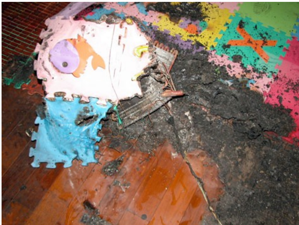
圖 3：除濕機下方地板受燒情形。
