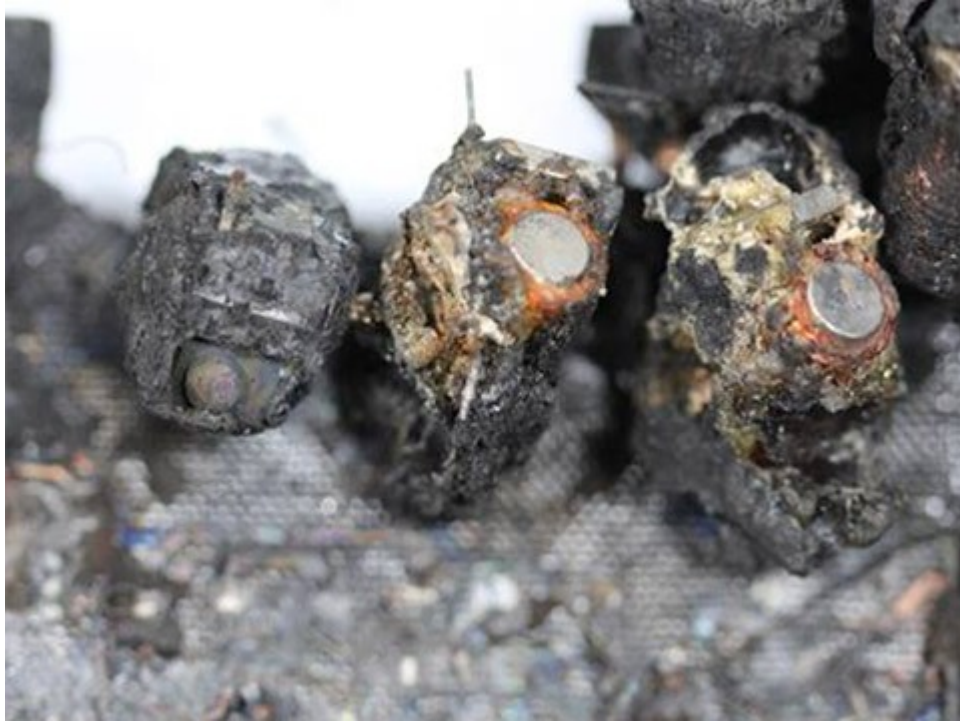
洗碗機主電路板相關線路，發現主電路板上左邊3個繼電器有嚴重燒毀掉落之情形。
