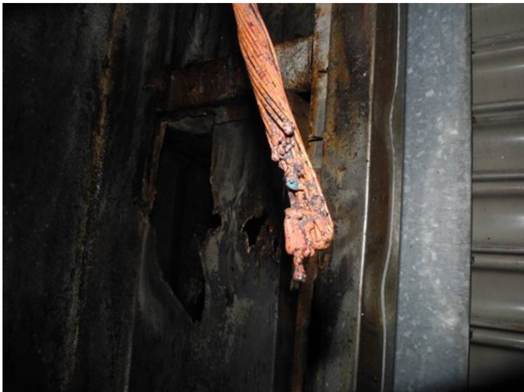
圖4：進屋線路上發現有短路熔痕
