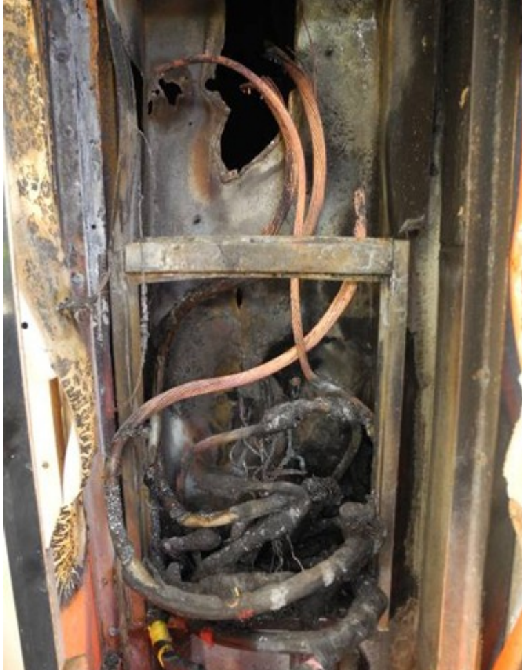
圖2：西南側原進屋點鐵箱（從店外拍攝）電線絕緣層燒失，銅線裸露且有短路熔痕，鐵皮受燒變色以電箱上方較為嚴重且短路電流造成鐵箱鐵皮破損
