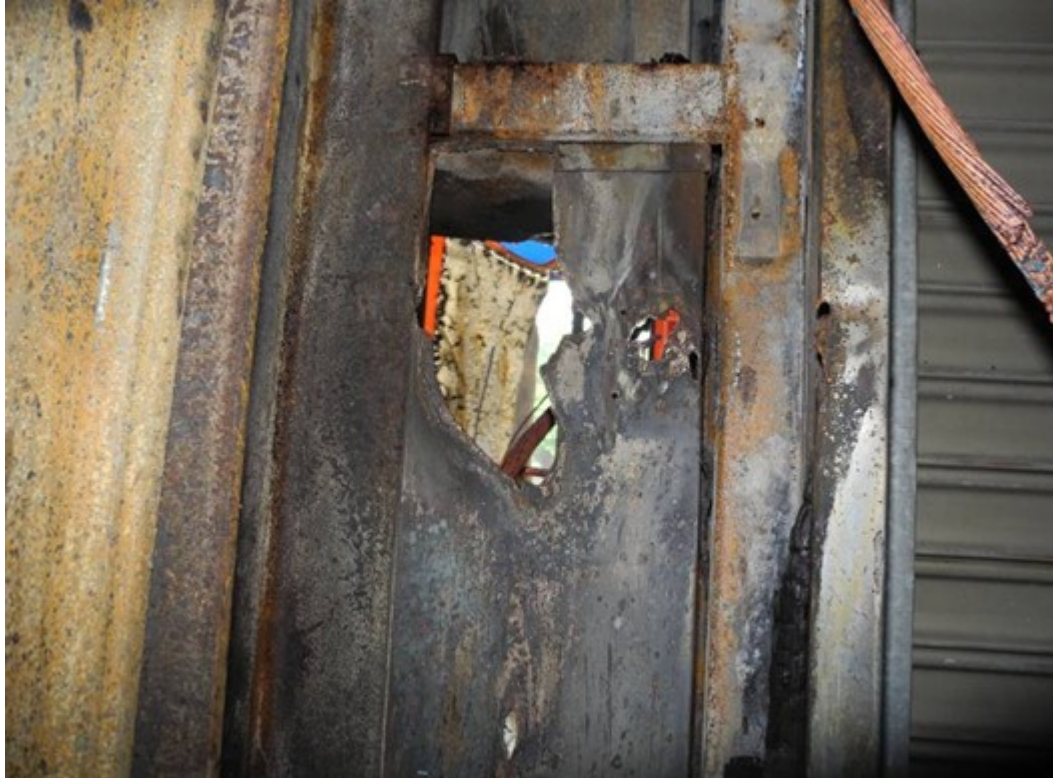
圖3：原進屋點鐵箱（從店內拍攝）進屋線路短路，短路電流造成鐵箱外殼破損，鐵箱及鋼柱處以破洞處受燒變色較為嚴重
