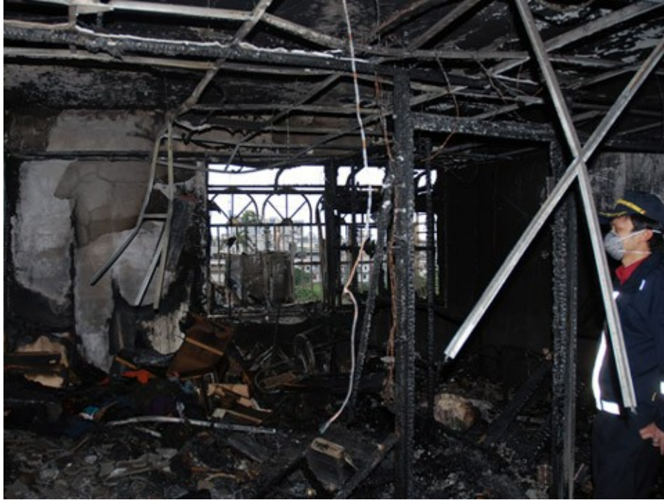
圖 2. 起火戶房間 1 之天花板輕鋼架受燒變色泛白，西北側脫落，南側及西側木質分間牆燒失，北側水泥牆面受燒變色、剝落。
