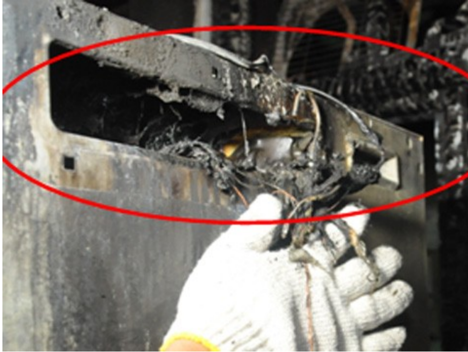
化霜定時器原設置於電冰箱後側上方，受燒後燒熔、燒失、滴落冰箱內部，僅剩電線及端子接點，且電線及端子之塑膠被覆部分燒失。
