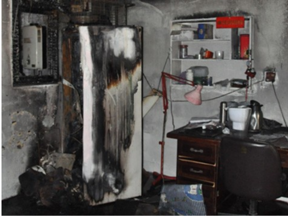
1樓客廳水泥牆壁部分燒白、部分受煙燻黑，木製辦公桌尚屬完整，電冰箱受燒變色、變形、燒失，地板掉落少許燃燒後殘餘物殘跡。
