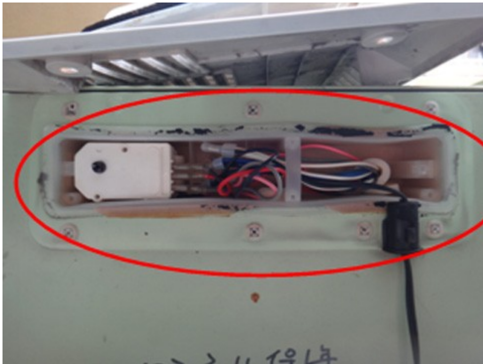
同機型對照組，電冰箱冷凍庫化霜定時器、端子、電源線及插頭電源線之特寫。
