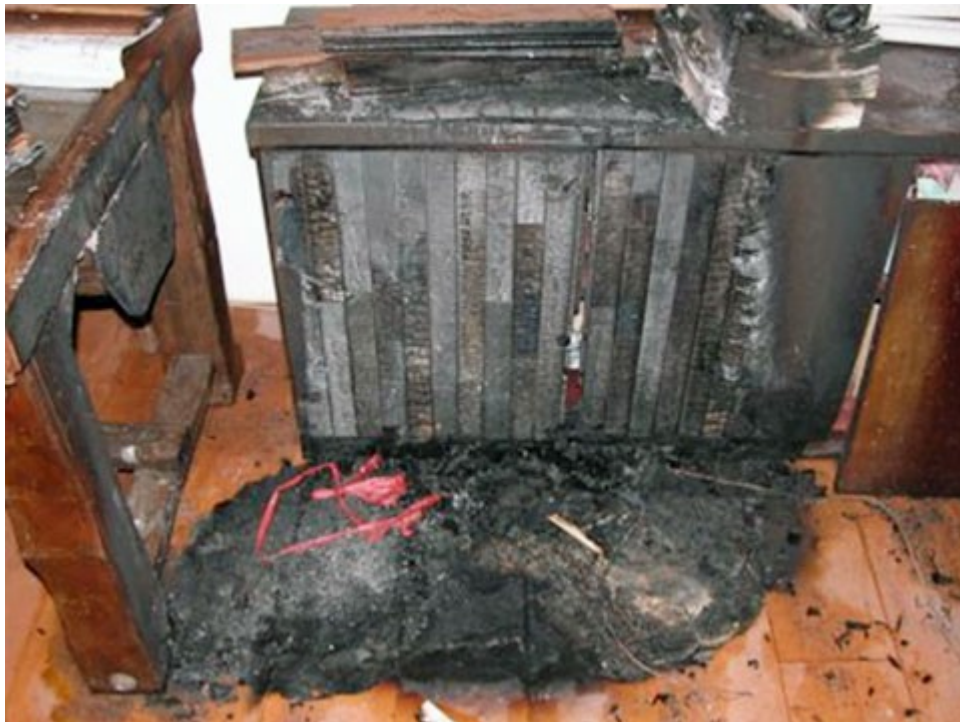
圖 2：電風扇移開後地板、木櫃燒毀情形
