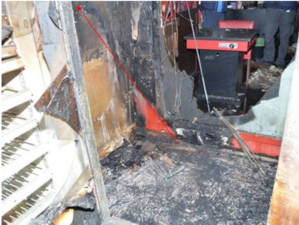
圖2 清理1樓火鍋店排菜區南側隔牆受燒後呈由北向南斜升火流痕跡
