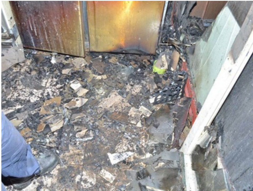
圖 1 1 樓火鍋店排菜區西南側地板有大量水泥塊及玻璃碎片，冰櫃下門受火煙熏燒成黃褐色，於西側門下方有焦黑情形。
