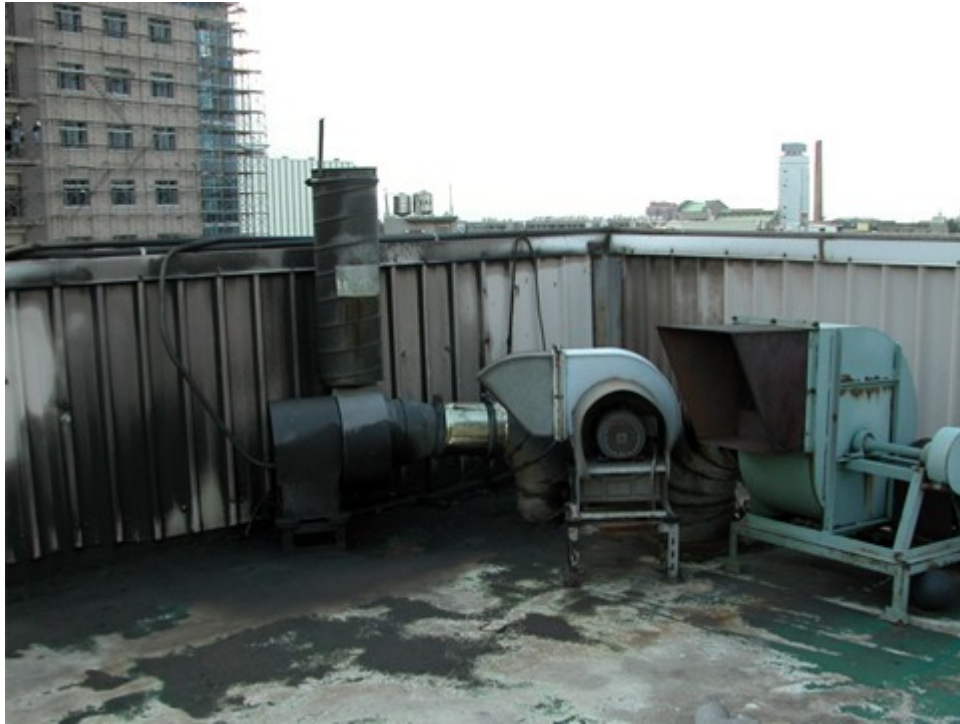
圖 4：頂樓出風口女兒牆被燻黑。
