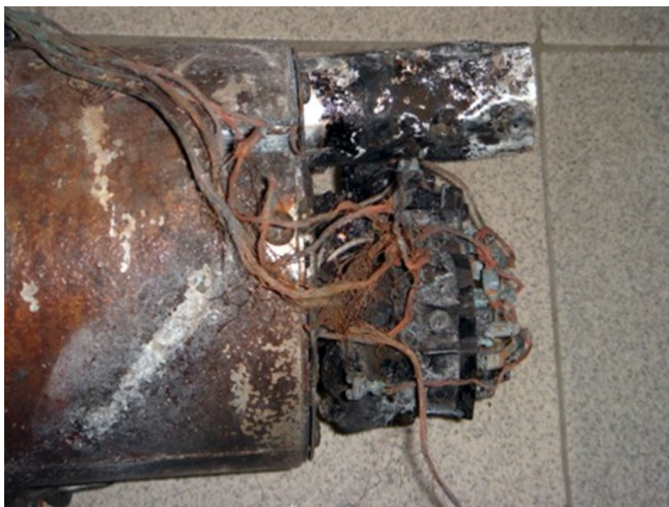
電容器與繼電器配電組高溫燒毀
