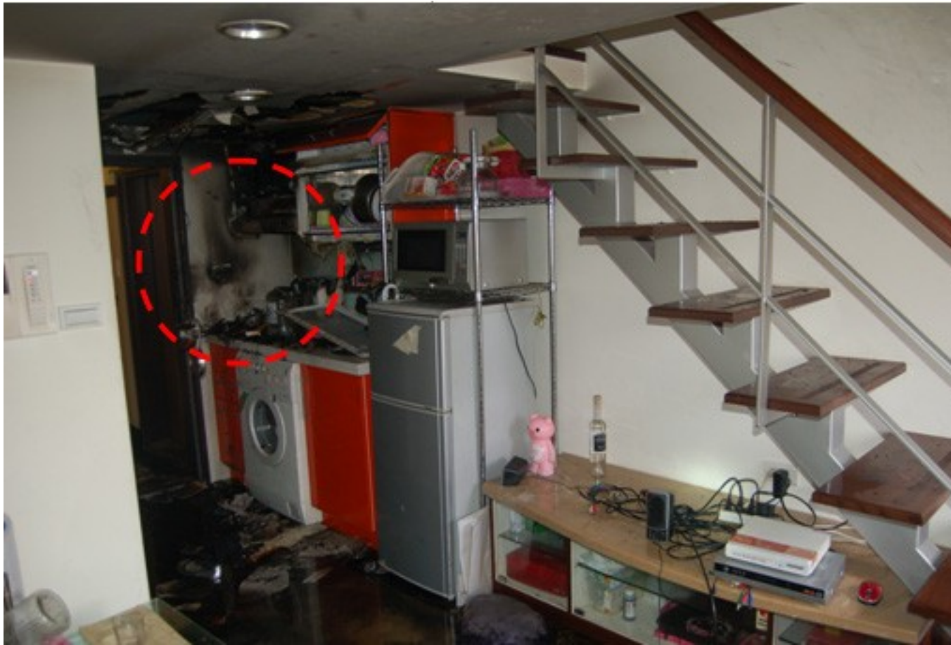
圖 1.現場套房僅以廚房之電陶爐附近裝潢物品燒毀較嚴重，火勢未波及該址其他場所。
