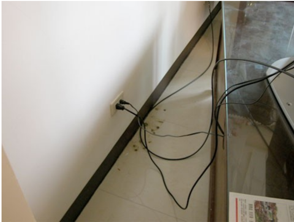
圖 1：起火位置正常電源線使用情況（插座端）。
