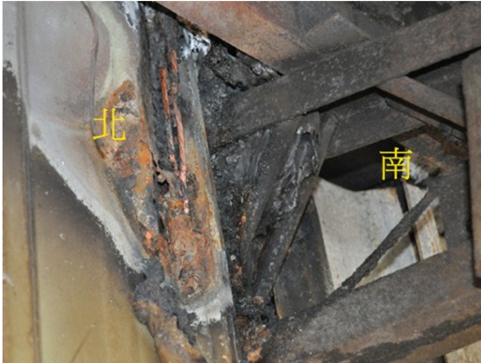
圖 2：勘查 48 號與 46 號相鄰遮雨棚鋼樑兩側發泡劑受燒情形，北側（48 號）燒失碳化情形較嚴重，檢視電源線段受燒情形，上方仍留有電源線塑膠被覆物品。
