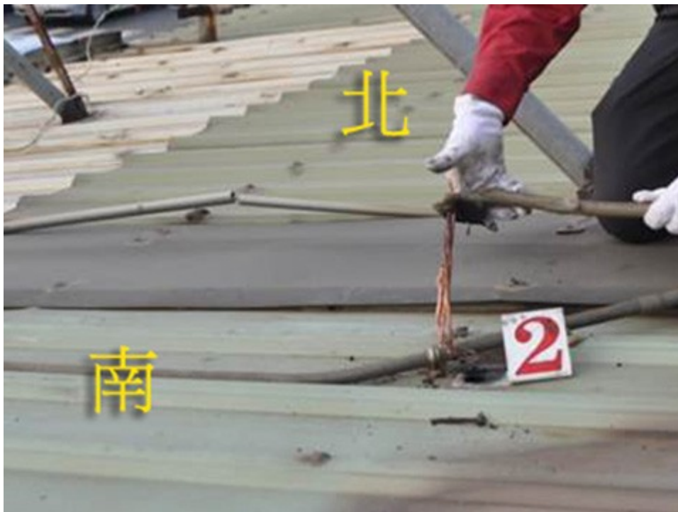
圖 3：勘查電表電源線配置方式為由電表配線後，將配線延伸穿孔經過鐵皮遮雨棚屋頂，並沿著鐵皮屋頂穿進 48 號 2 樓供電。
