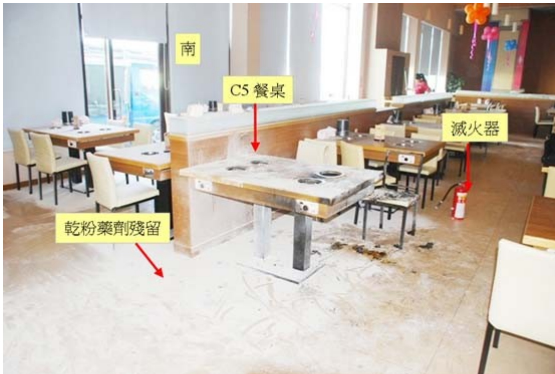
圖2：C5 餐桌呈現受火勢燒損痕跡，地面殘留滅火器乾粉使用後痕跡。
