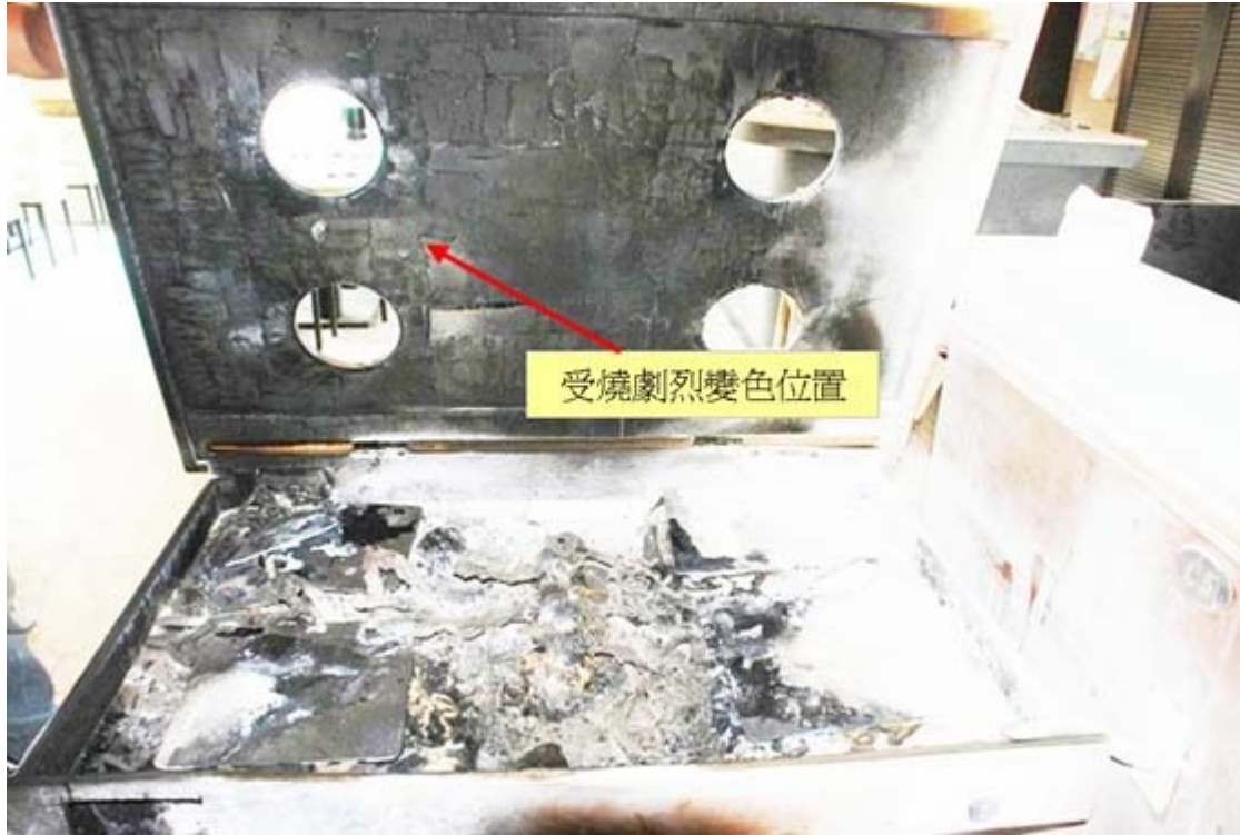
圖 5：C5 餐桌位於東側電磁爐擺放處桌面下方木材，呈現受火勢燒損情形較為嚴重。
