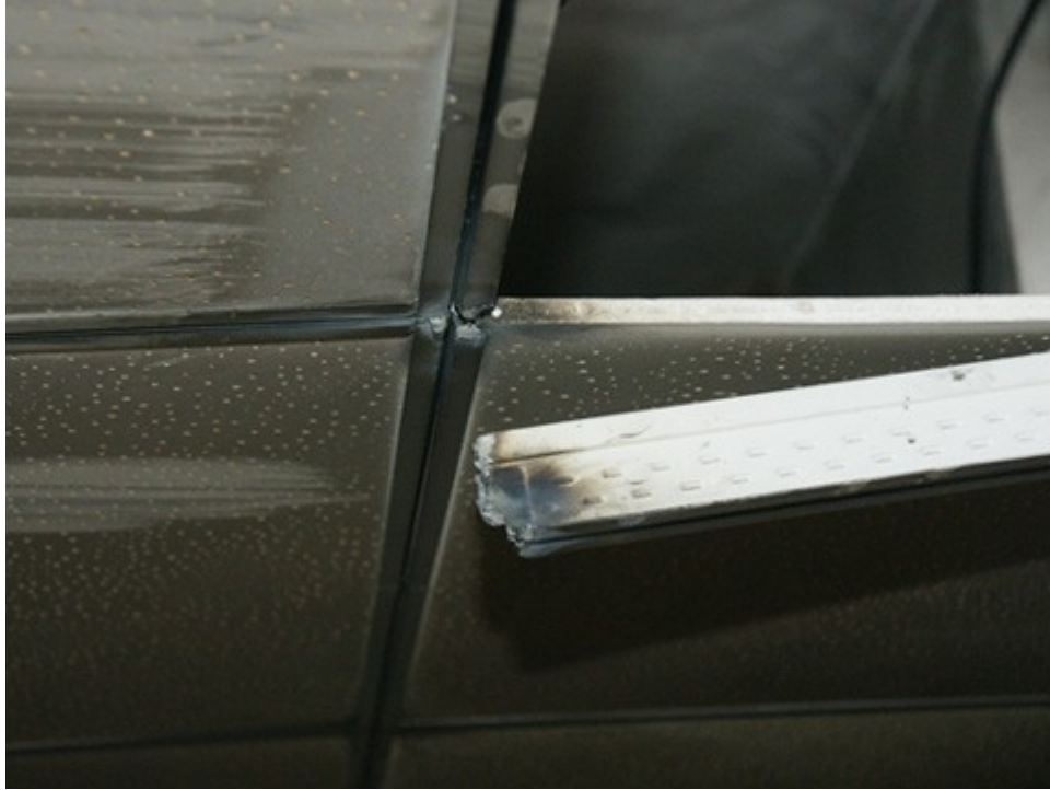
天花板輕鋼架支撐矽酸鈣板的鋁框出現高溫燒熔的現象
