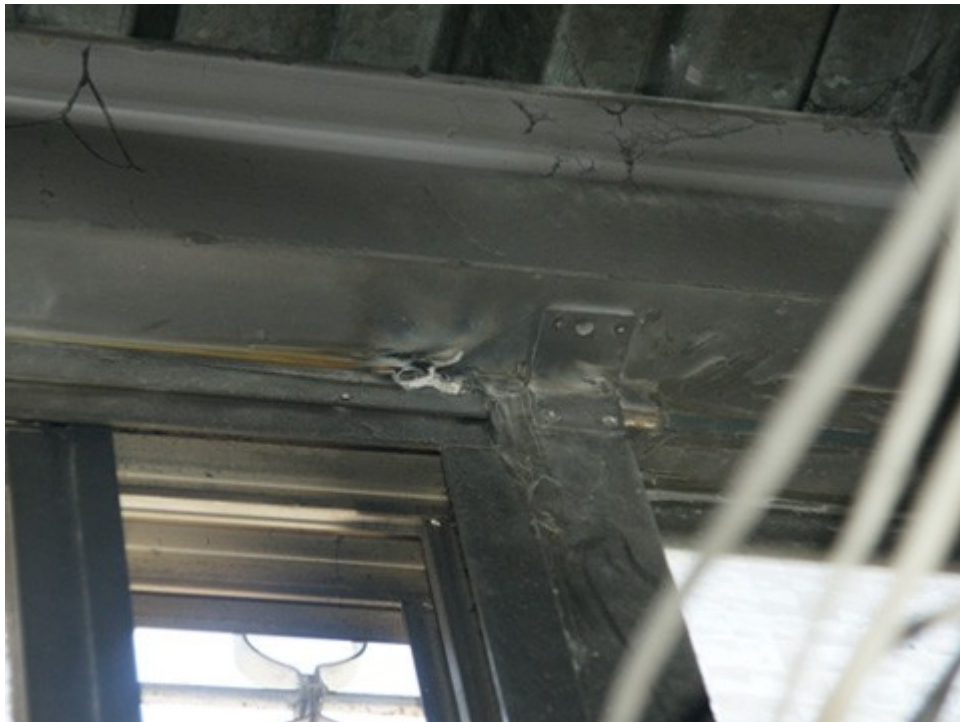
在接觸鄰近窗口局部搭接的鋼梁也出現高溫引燃填塞劑的現象
