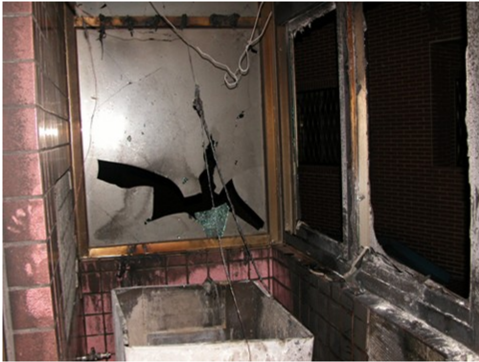
圖 1：起火陽台左側上方，圓形鐵絲為竹竿懸掛處，延長線纏繞鐵絲懸吊在洗衣機上方。
