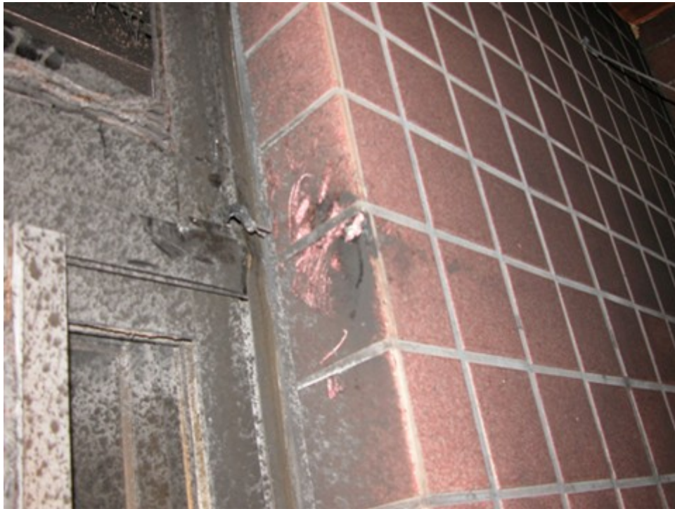
圖 3：照片 2 現場清理發現延長線與牆角摩擦處有延長線通電熔痕。
