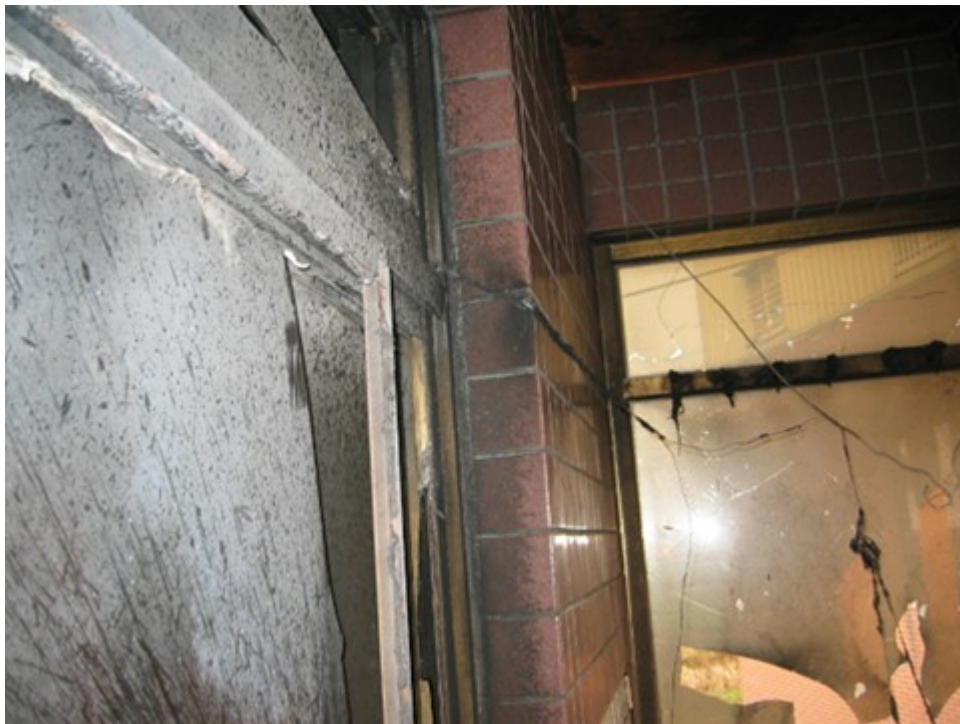
圖 2：延長線於落地門上方氣窗經過並與牆角磁磚摩擦。
