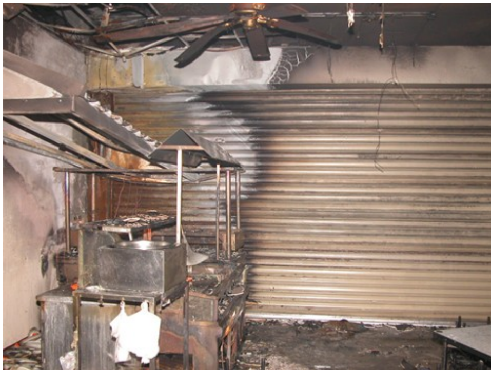
圖 3：室內鐵捲門左側受燒嚴重，上方天花板掉落。
