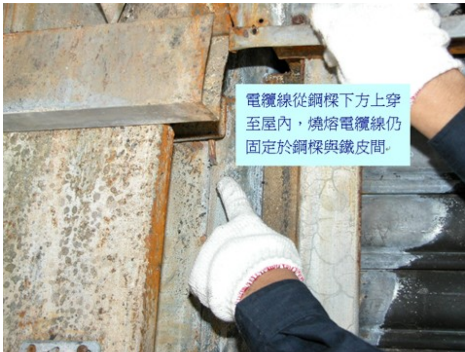
圖6：照片5下方，電纜線於照片5燒斷後固定於鋼樑與鐵皮間。
