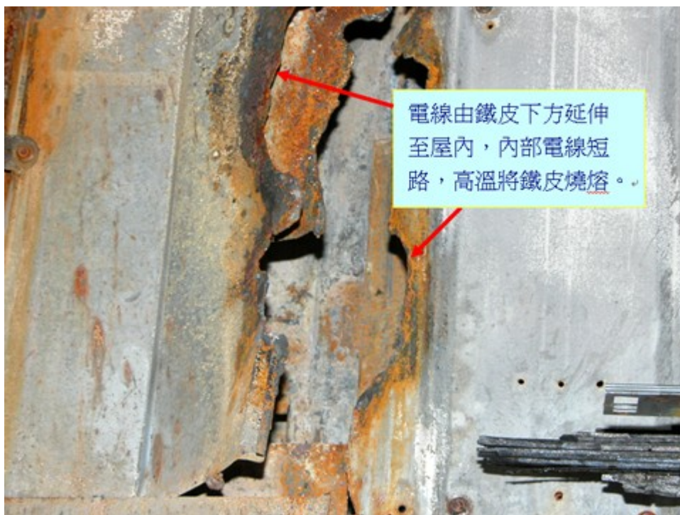
圖 5：電纜線貫穿處鐵皮燒熔情形。
