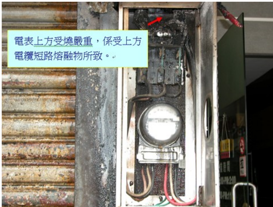
圖 2：照片 1 左側電表箱上方受燒嚴重。
