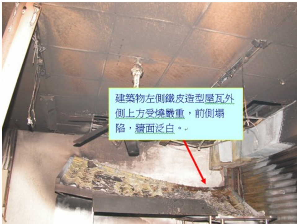
圖 4：鐵皮屋瓦造型上方受燒嚴重，鐵皮屋瓦前側固定處脫落。
