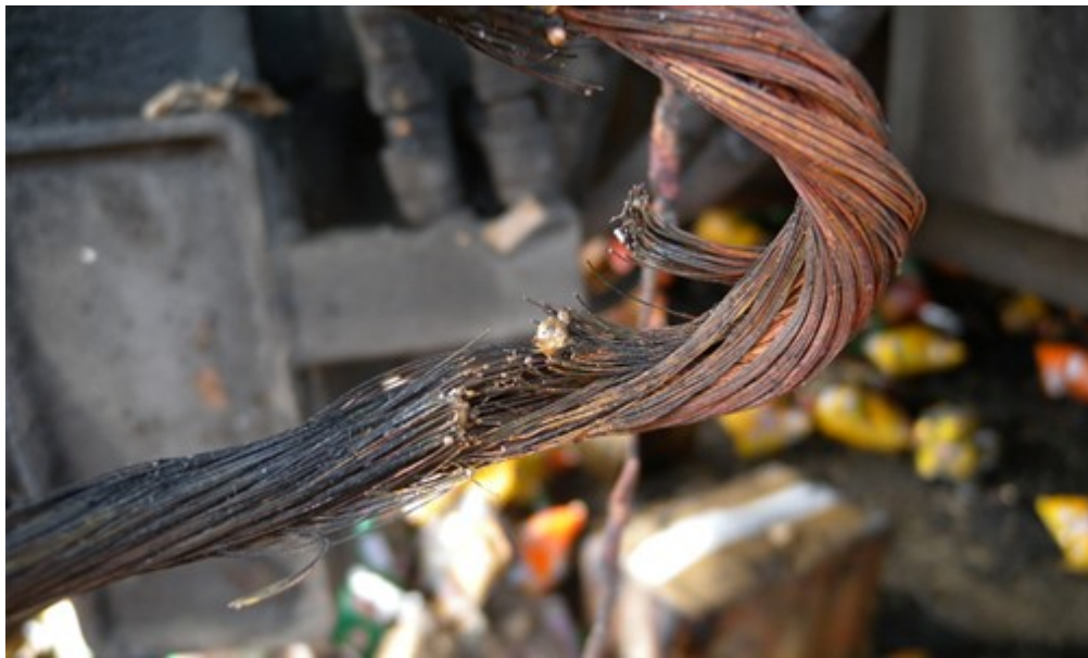
圖 6：油壓尾門及工作燈電源受火燒毀短路
