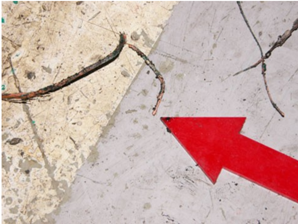
圖 7：電動座椅電源線短路熔痕。
