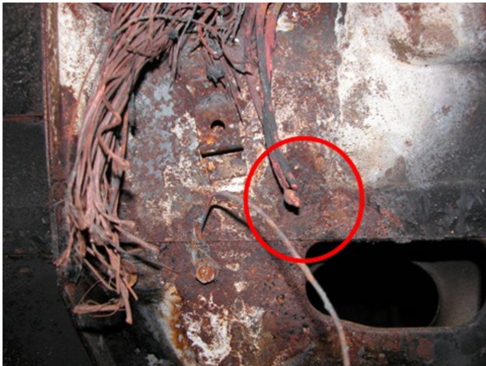
圖 3：照片 2 近拍，電線短路熔痕。
