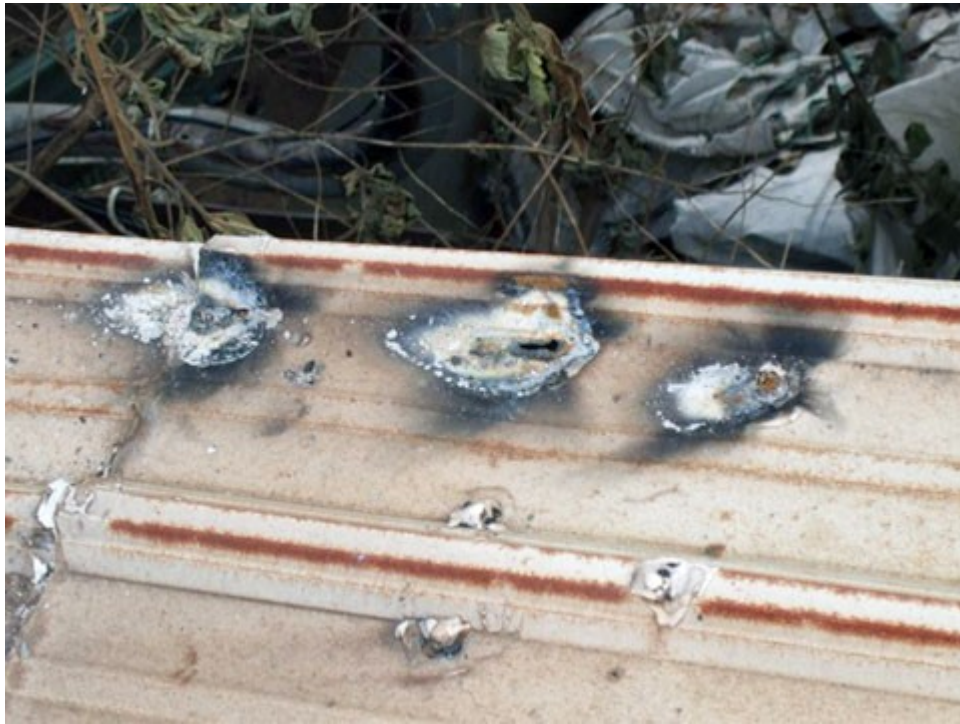
圖3：屋頂上方檢查鐵皮浪板，發現有多處切割燒熔痕跡
