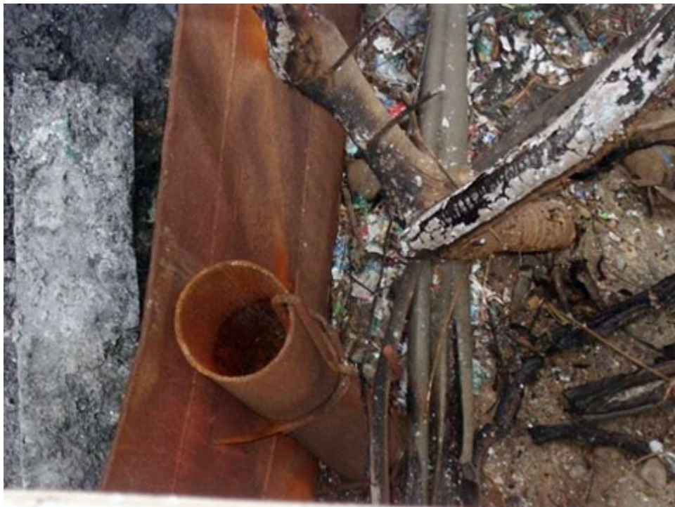
圖4：掀起屋頂浪板發現下方正為現場施工人員「郭○○」目擊起火處及搶救位置
