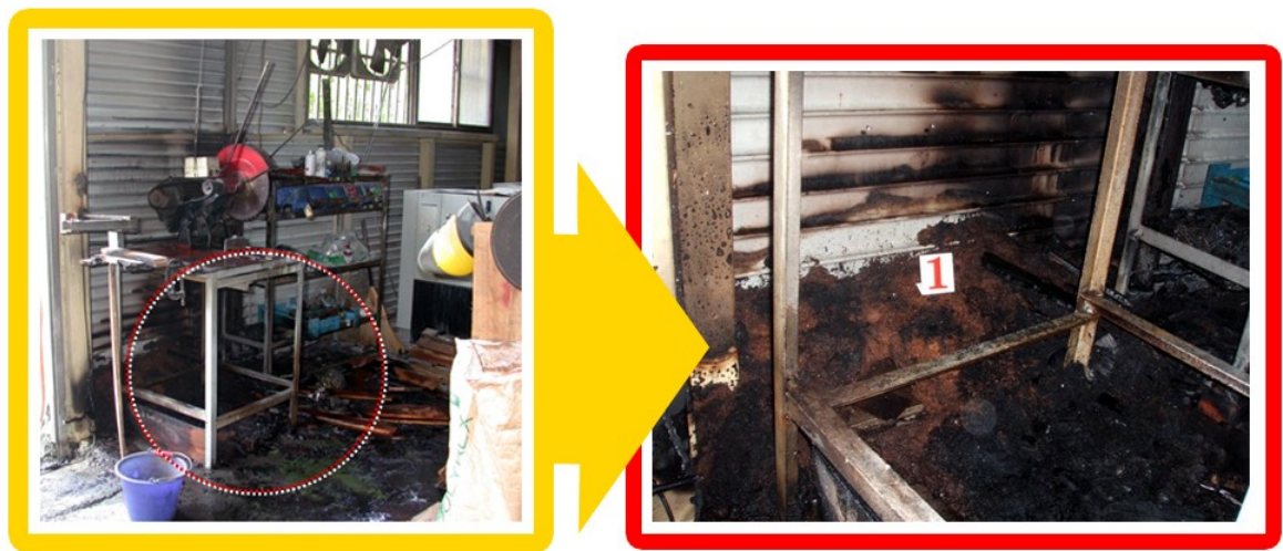
圖 3. 起火處僅切割機下方木屑堆及附近地面木材有受火勢燒損情形
