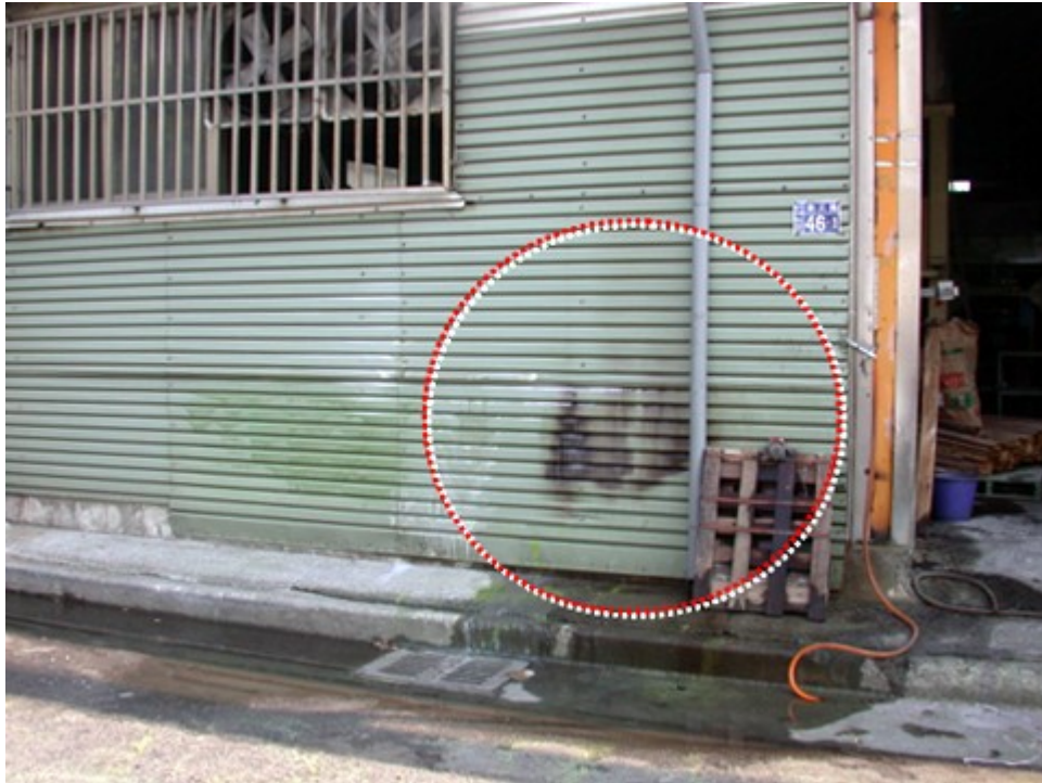
圖 2. 室外鐵皮牆面僅呈現小面積煙燻燒損痕跡
