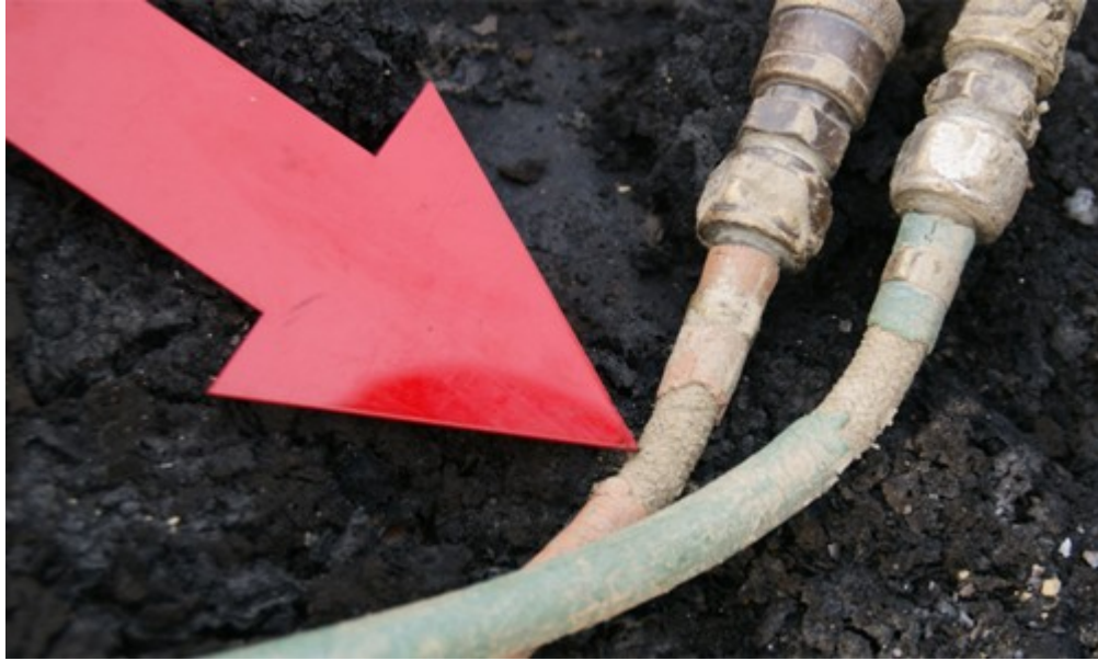
檢視殘存出氣軟管有部分破損龜裂情形
