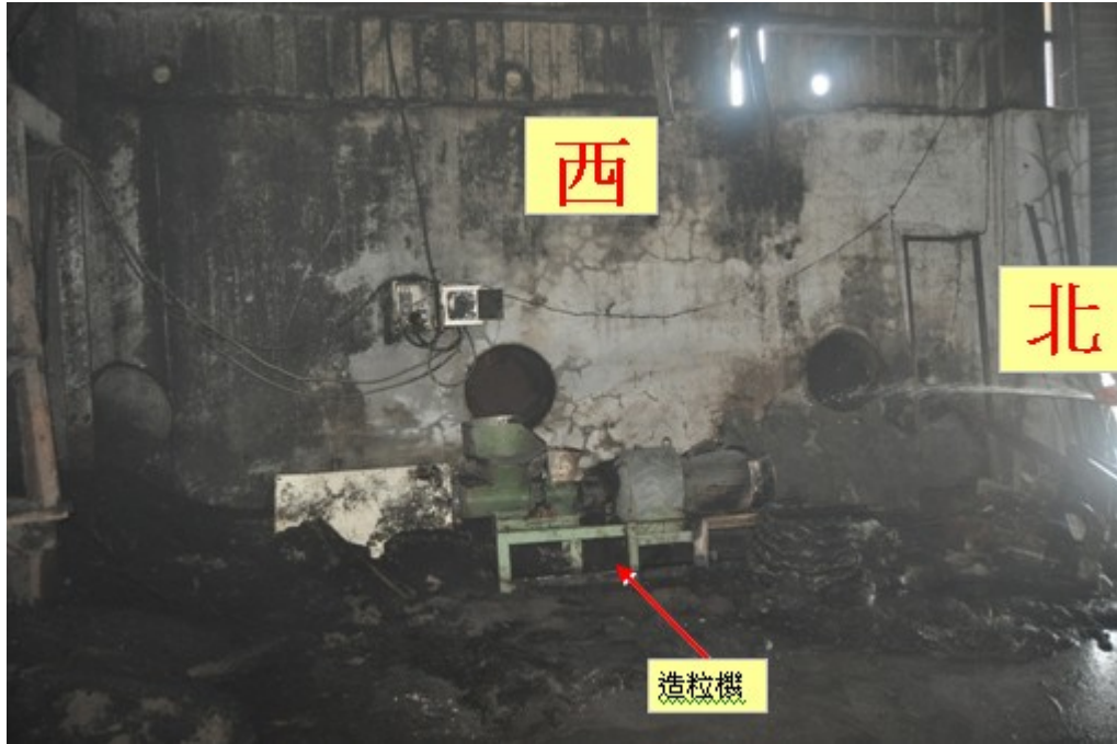
圖 1：勘察廠房內西側牆面燃燒情形，以靠北側下方牆面有受火流波及燃燒，該處放置造粒機以靠北側有受火流波及燃燒，機台南側未受火流波及燃燒。
