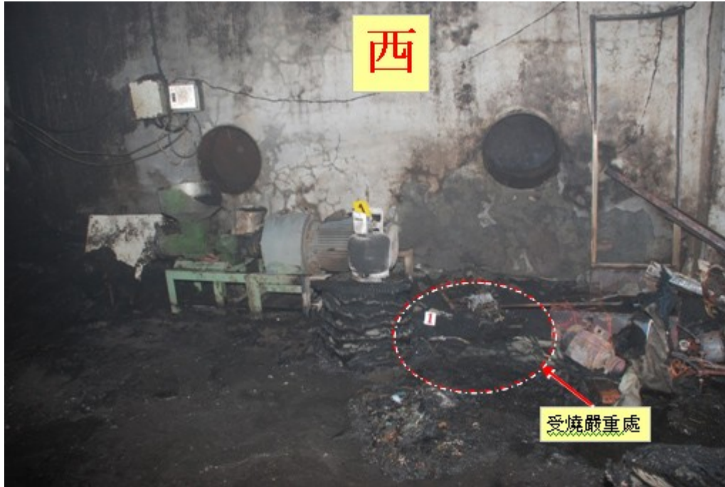
圖3：勘察廠房西側堆放物品受燒情形，以瓦斯噴火器垂掛位置（標示1）附近受燒較為嚴重。
