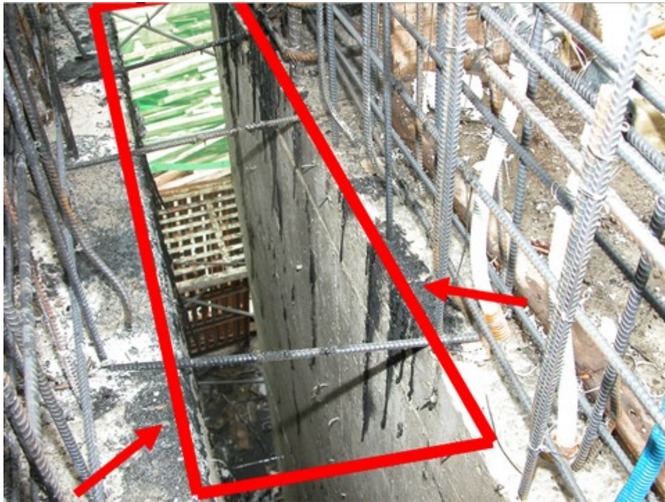
圖 2：保麗龍整排燒失，造成一樓東、西二側牆面燻黑及二樓鋼筋、板模燻黑。
