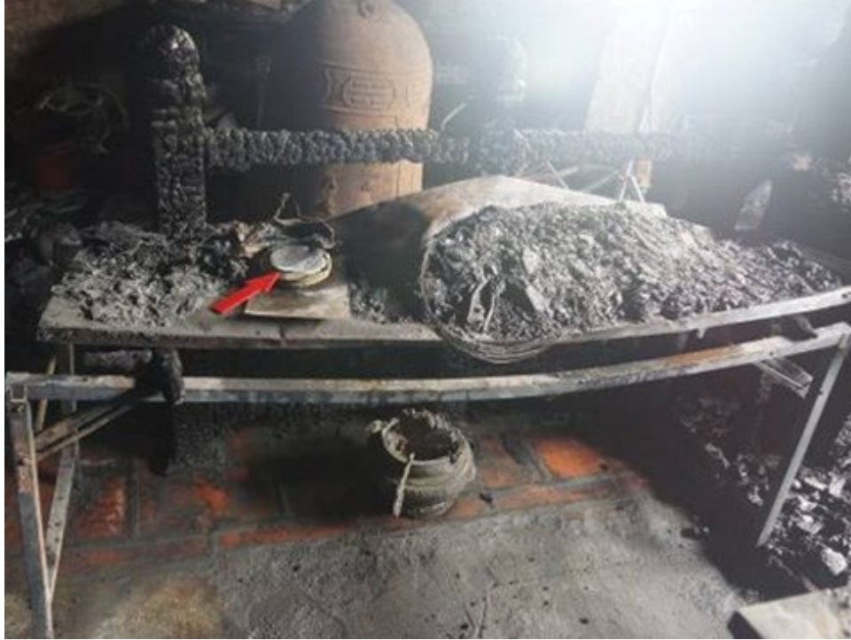
復原起火處，會議桌板嚴重燒失，置放桌面上之香擔燒毀、銅製香爐燒熔。
