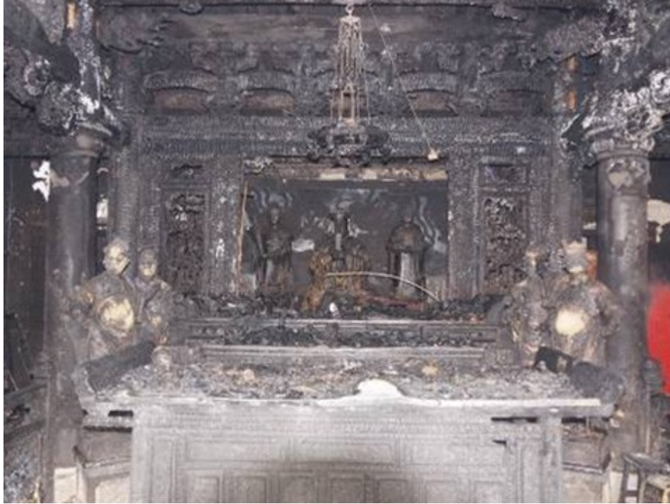
東、西兩面廂房及左、右兩側翼樓、鼓（鐘）樓、軒廊、配殿（福德祠、文昌祠）、後廂廊及後殿內部物品均未受燒，火勢僅主殿內物品受程度不等燒損。
