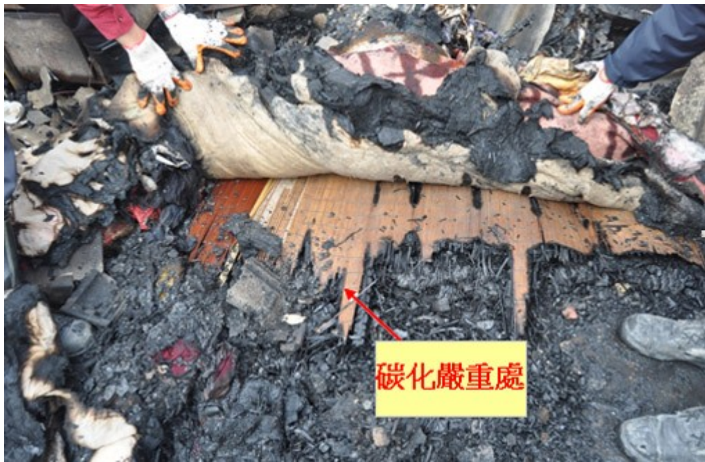
圖 5. 床鋪所鋪設之草蓆下方已受燒碳化，上方尚未受火流波及仍保留原色，顯示火流由下方往上方延燒。
