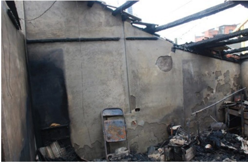
圖 2. 勘查西北側臥室內西側牆面，北側水泥受燒剝落嚴重；中間下方水泥受燒剝落嚴重，因放置於西南側衣櫥受燒倒落，而造成該處受燒剝落嚴重。
