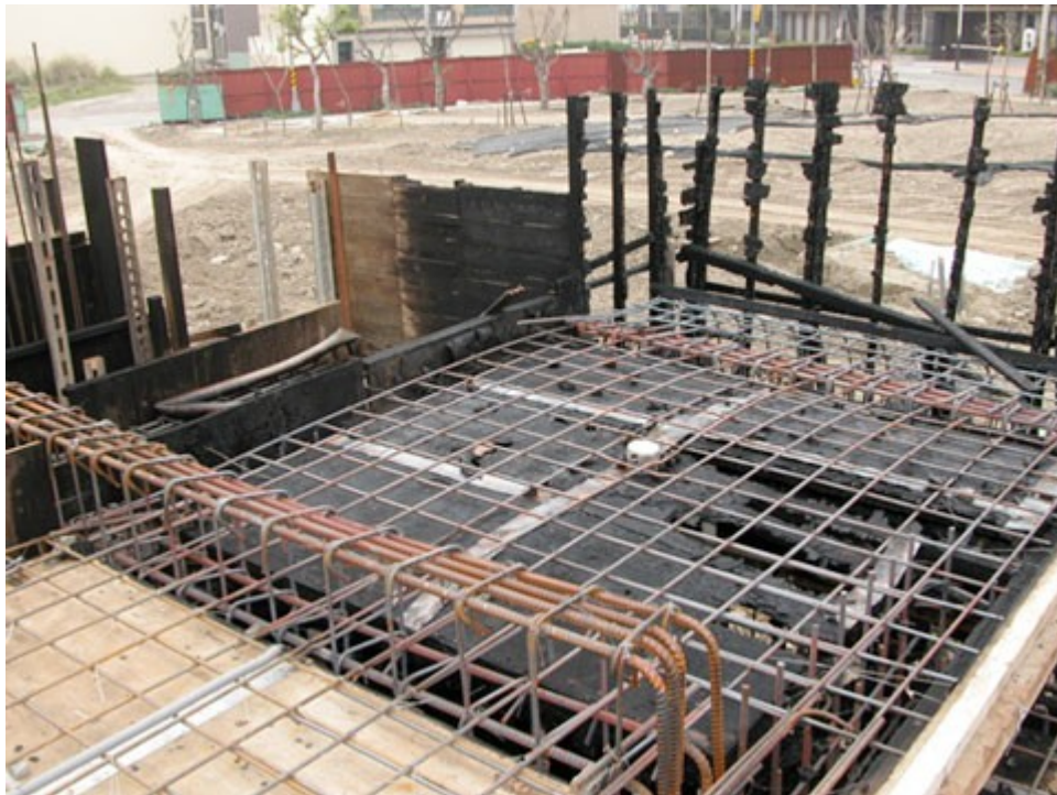
圖 6：屋頂受燒模板碳化，部分燒失。
