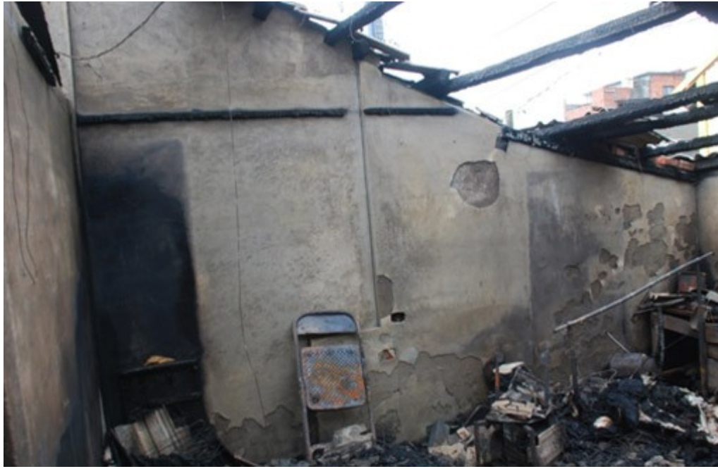
圖 2. 勘查西北側臥室內西側牆面，北側水泥受燒剝落嚴重；中間下方水泥受燒剝落嚴重，因放置於西南側衣櫥受燒倒落，而造成該處受燒剝落嚴重。
