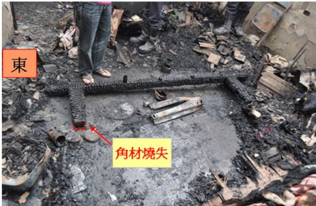
圖 7. 臥室床鋪東側腳架下方有 1 段已燒失，顯示東側受燒情形較西側嚴重。
