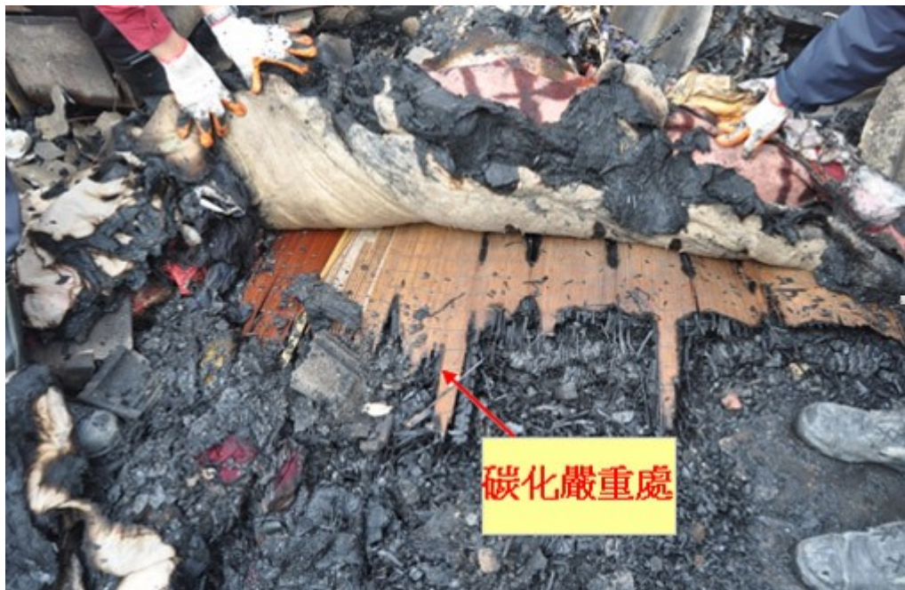
圖 5. 床鋪所鋪設之草蓆下方已受燒碳化，上方尚未受火流波及仍保留原色，顯示火流由下方往上方延燒。
