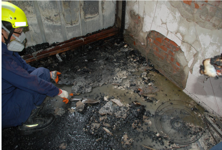
照片 1：起火戶房間 3 東南側塑膠置物箱及塑膠垃圾桶碳化、燒失。
