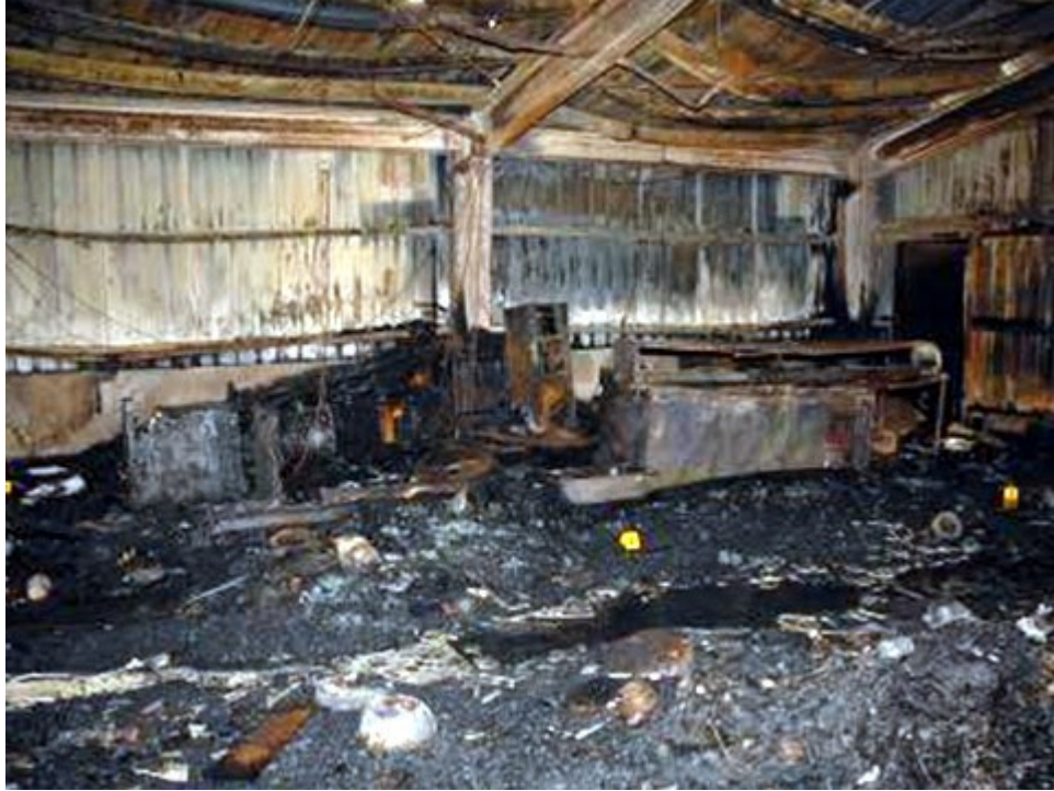
圖 2：起火處所照片
