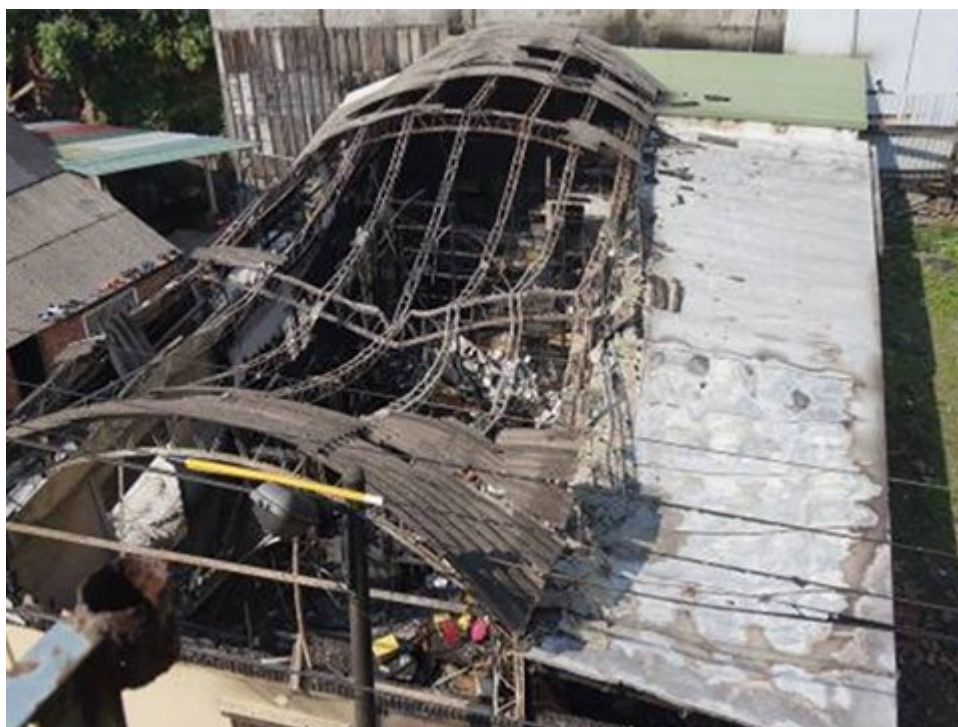
圖1：北面屋頂鐵皮以東側受燒變色最為嚴重，南面石棉瓦屋頂受燒掉落呈透空狀。
