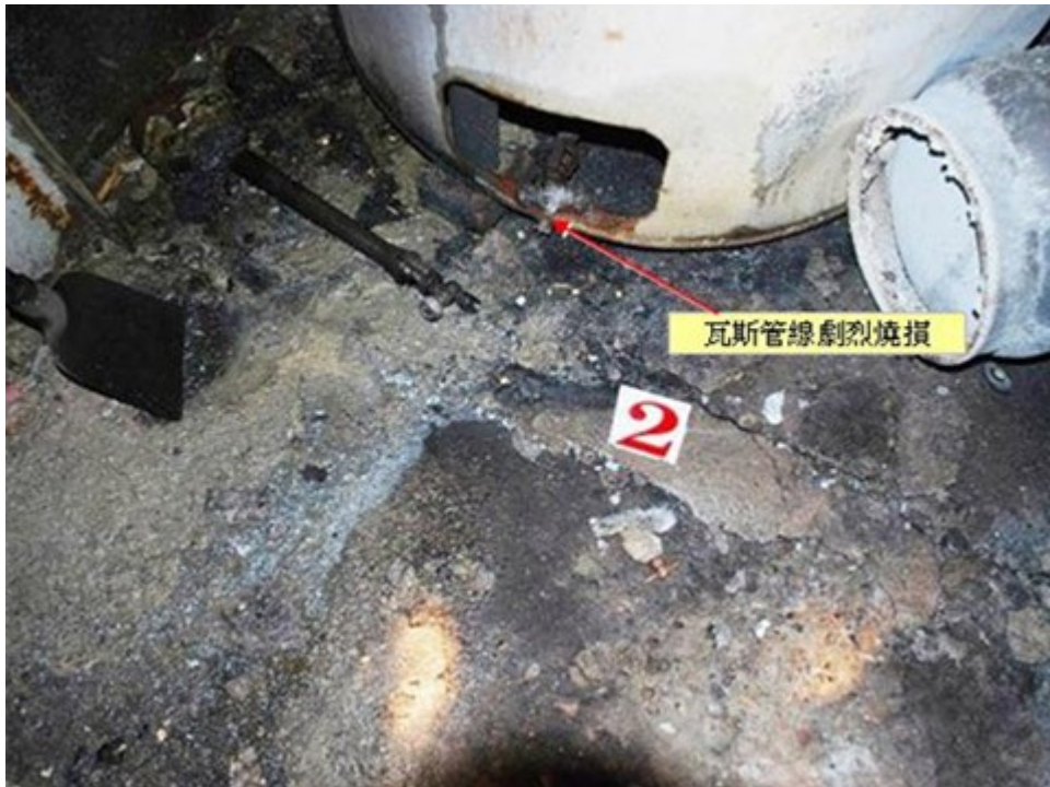
圖 4. 勘查瓦斯爐具，瓦斯管線呈現受火勢劇烈燒毀情形
