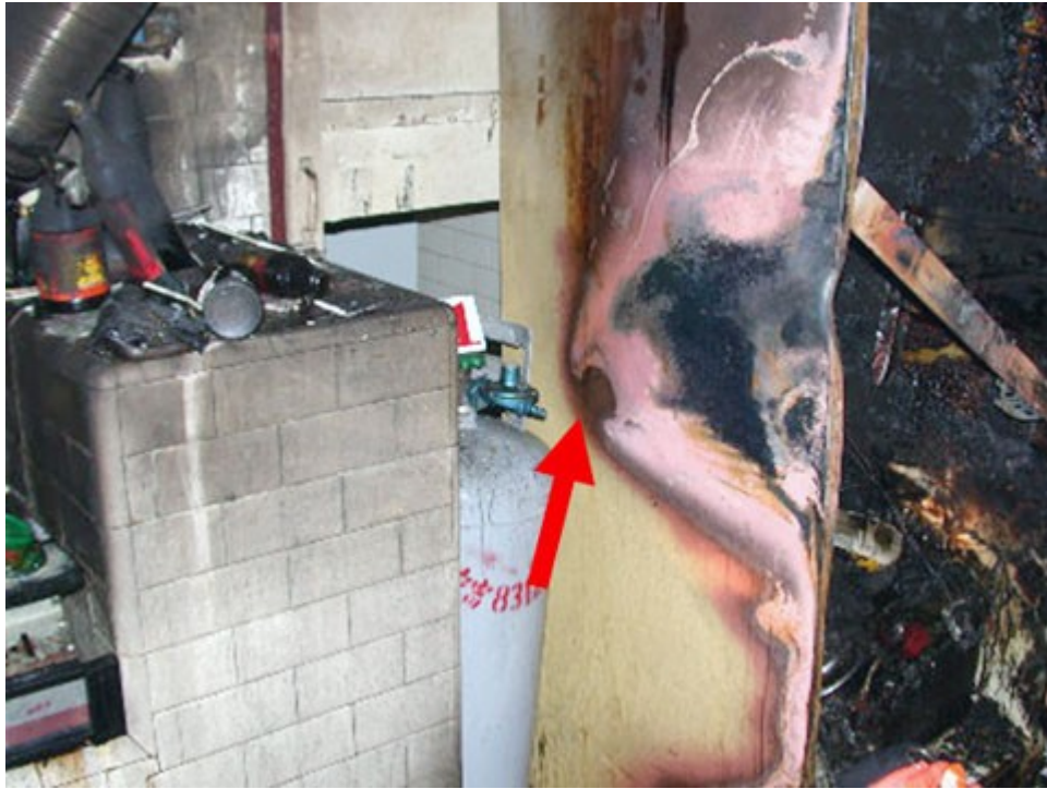
圖 4：現場 1 樓靠南側廚房內靠東南側電冰箱受火勢延燒
